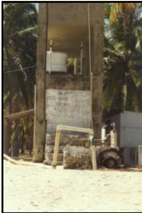
Foto 2 - Poço tubular profundo captando água do aquífero Cabo. Praia de Maracaípe.
