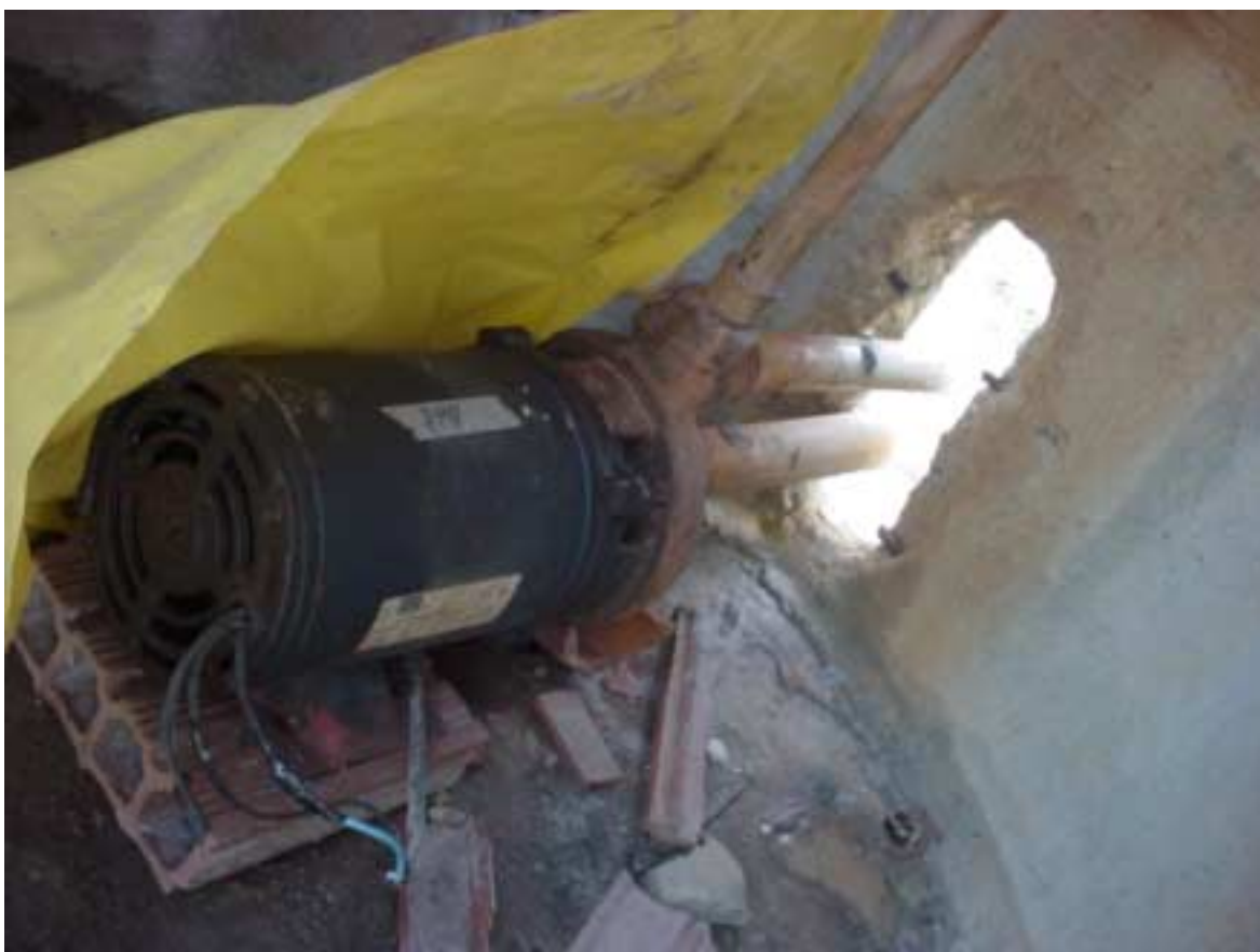
Foto 2.1 - Bomba junto ao poço do Sítio Rodeador
