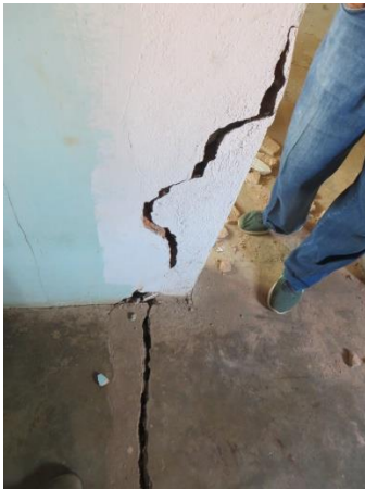
Figura 7. Rachadura no piso e parede da casa situada nas proximidades da empresa de sementes.
