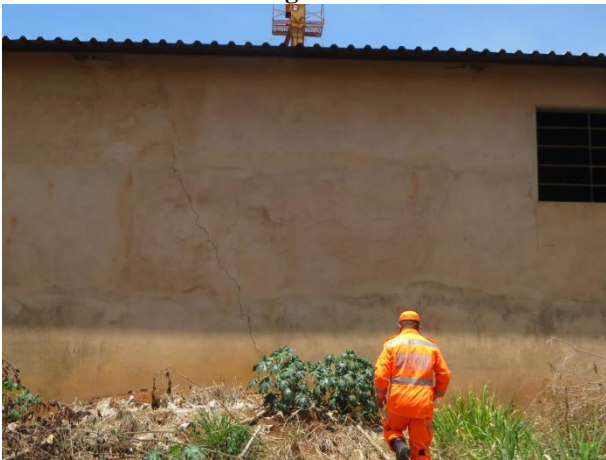
Figura 11. Trincas verticais e a 45° observadas na parede da última instalação da empresa de sementes.
