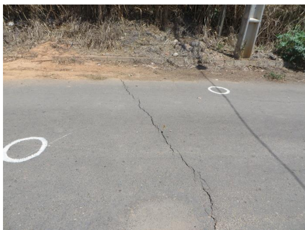
Figura 2. Trinca no pavimento asfáltico quase perpendicular à direção da rua.
