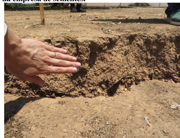
Figura 5. Detalhe da dimensão do rejeito no degrau de abatimento observado no terreno a jusante da empresa de sementes.
