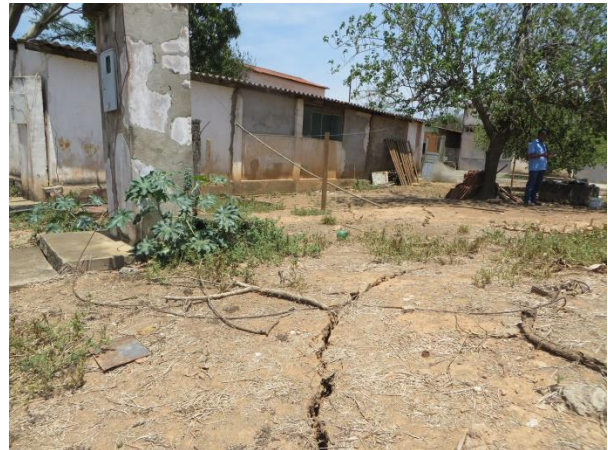
Figura 8. Continuidade das trincas/rachaduras após a casa da foto anterior.
