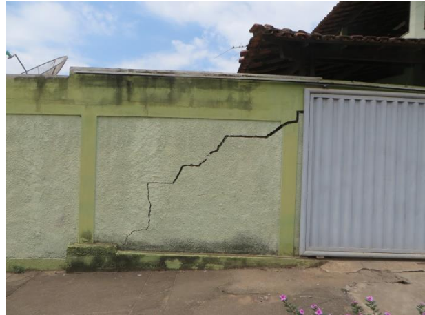
Figura 13. Rachadura a 45° no muro frontal de casa da Rua Mato da Lagoa.
