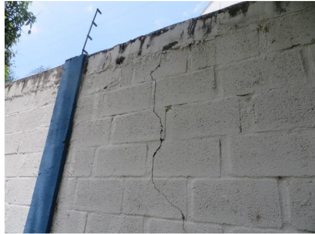
Figura 10 Trinca no muro que separa as instalações da COPASA da última casa da Rua Mato da Lagoa.
