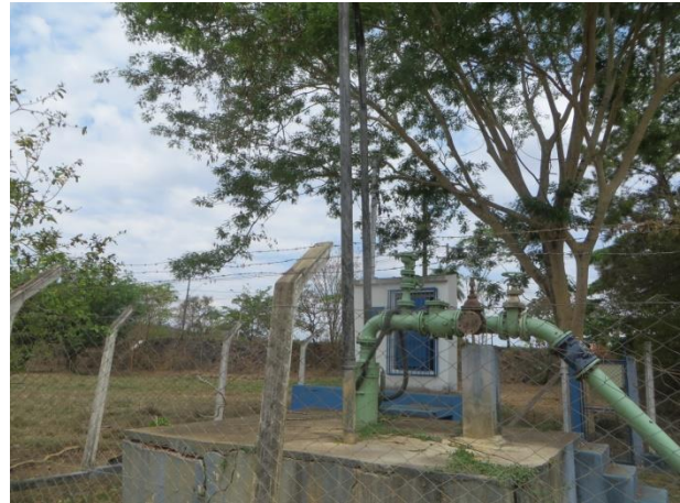
Figura 17. Poço da COPASA situado próximo da área afetada. Esse poço apresenta algumas singularidades como muitas rachaduras e adernamento da estrutura cimentada e inclinação (para a esquerda da foto) da haste com a carretilha.
