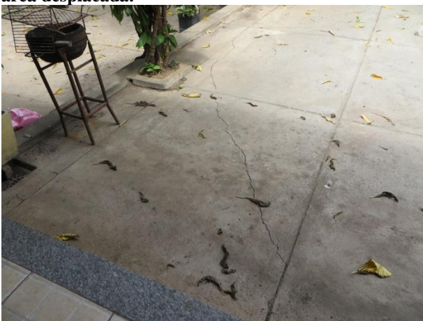
Figura 14. Trinca que se propaga principalmente de forma diagonal ao terreno. Fundos de casa da Rua Mato da Lagoa.
