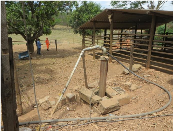
Figura 16. Um dos poços de água localizados na área. Esse poço apresentou rápido rebaixamento do nível pouco antes do evento, segundo informações repassadas pelos representantes municipais.
