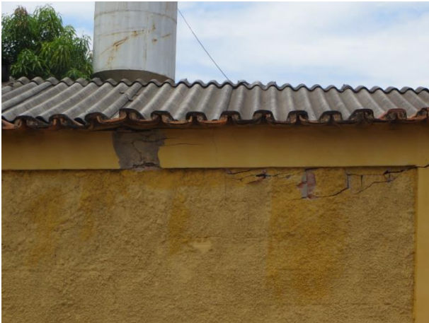
Figura 12. Desplacamento na cinta superior e trincas no painel do muro de casa da Rua Mato da Lagoa. Notar arqueamento para cima do telhadinho sobre a área deslocada.
