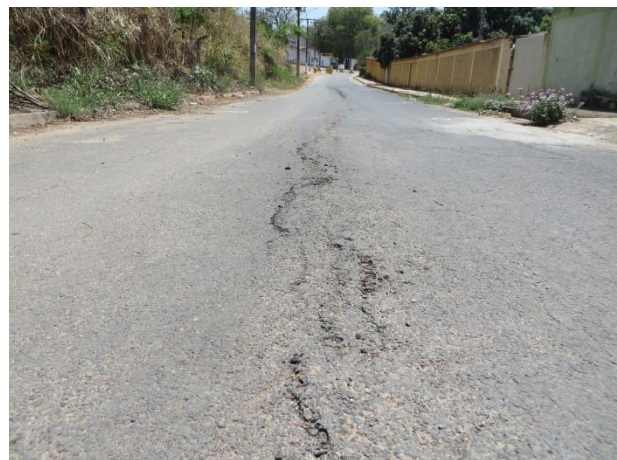
Figura 15. Feição linear, aparentemente de soerguimento, no eixo central do pavimento asfáltico da Rua Mato da Lagoa.
