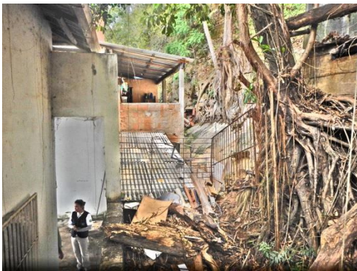
Figura 8. Em primeiro plano, imóvel do Cartório Eleitoral e encosta. Em segundo plano, rocha exposta no mesmo talude, atrás da casa vizinha.
