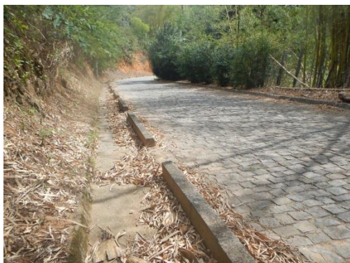
Figura 4. Drenagem e calçamento observados na Rua Padre Henrique Otto, vista em direção à Rua Marechal Floriano.
