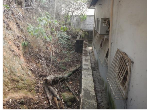
Figura 7. Troncos e pequeno bloco retidos atrás do muro.
