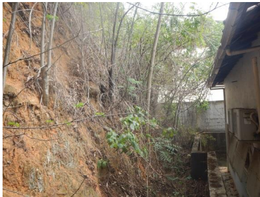
Figura 2. Base do talude, nos fundos do imóvel do Cartório. Corte no talude pouco maior que o telhado do Cartório.
