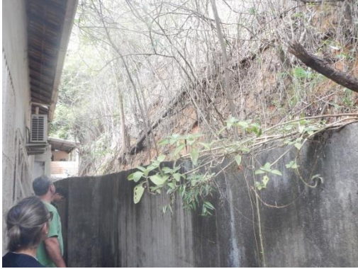
Figura 6. Muro atrás do cartório sem drenagem aparente.
