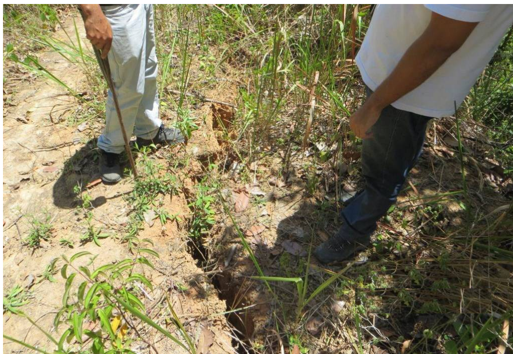
Figura 7 – Trinca localizada à montante da ruptura principal.
