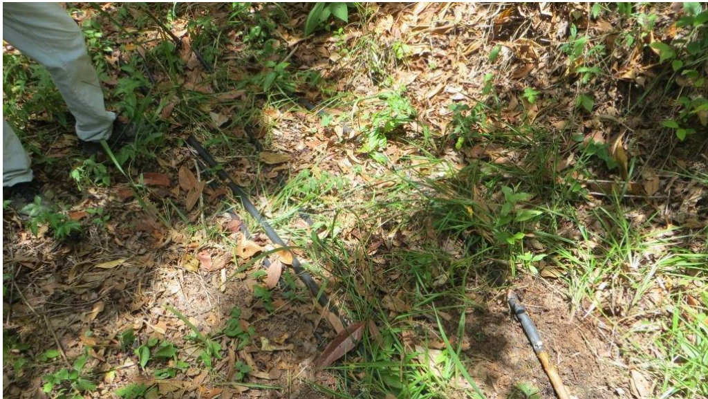
Figura 9 – Tubulação de água instalado em um trilha localizada próximo à ruptura do solo.
