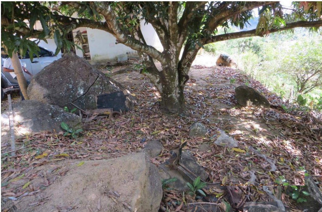
Figura 14 – Vista da residência próxima ao eixo da drenagem. Notar os blocos ao lado da casa.
