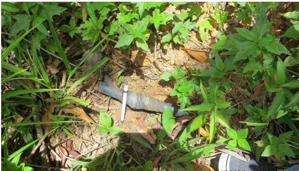
Figura 10 – Tubulação de água instalado em um trilha localizada próximo à ruptura do solo. Notar a presença de emenda em ponto que ocorria vazamento de água.
