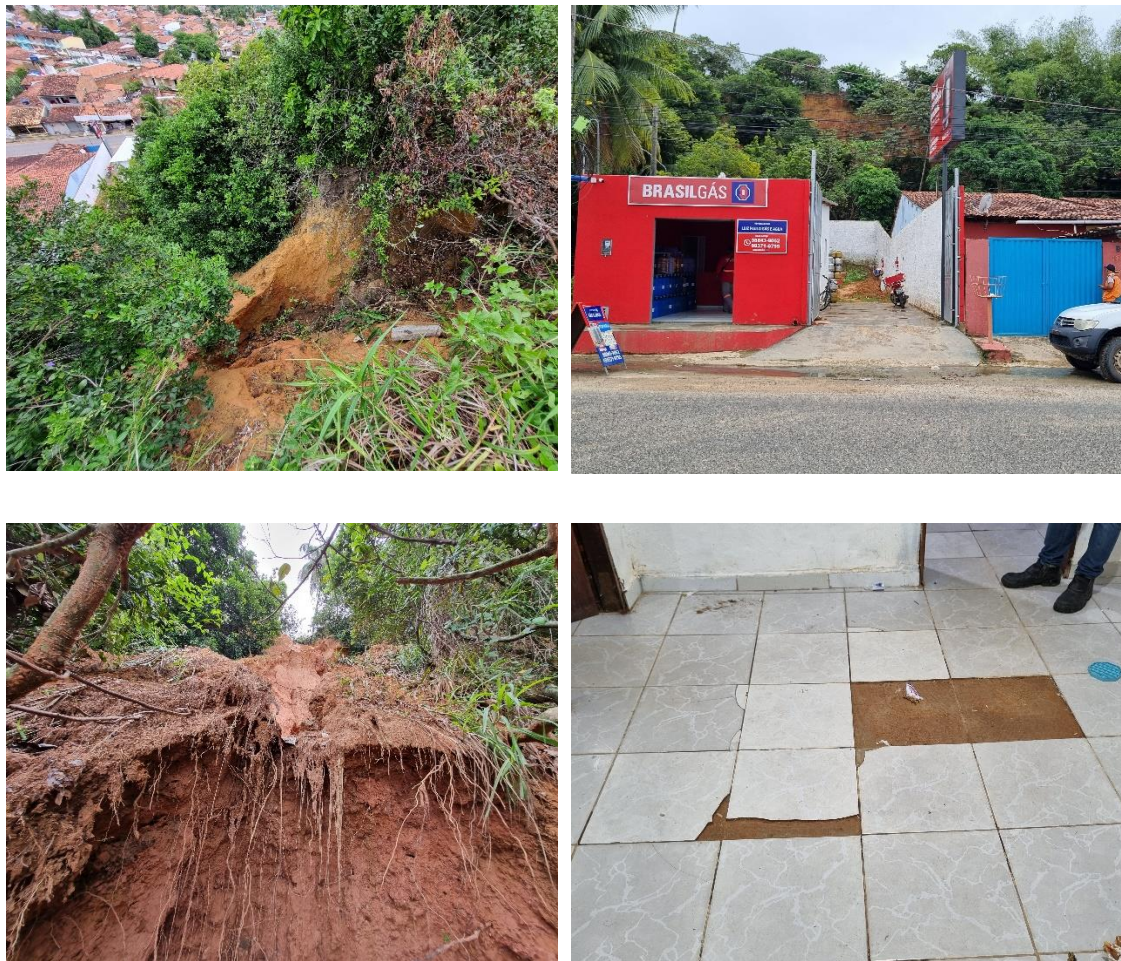
Figura 1: Danos causados pelo rompimento de uma adutora no município de Paripueira-AL.
