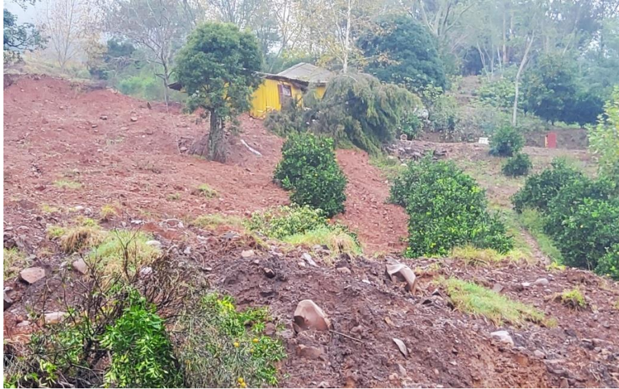
Figura 9 – Casa deformada pelo deslizamento.
