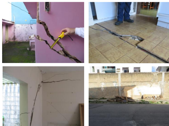
Figura 2 – Trincas e rachaduras que retratam a área de instabilidade alta no terreno Junho de 2018..
