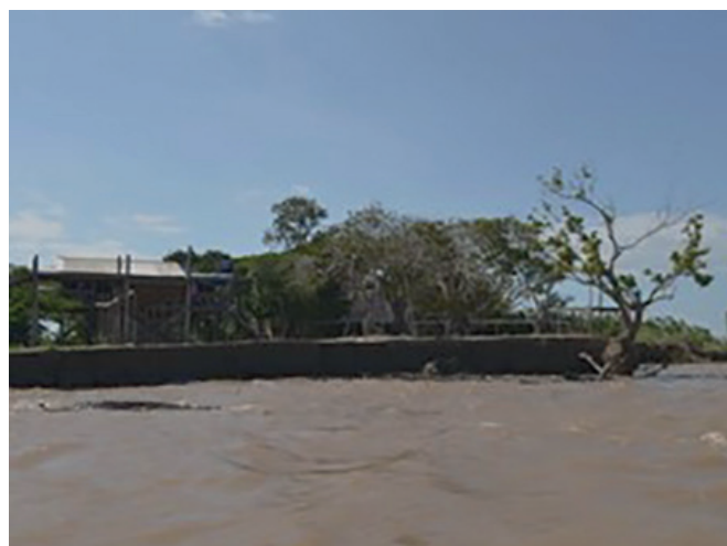
FIGURA 3 - Processo erosivo nas margens do Rio Amazonas. Comunidade Fátima de Urucurituba. Fonte: http://g1.globo.com/pa/santarem-regiao/noticia/2014/01/terras-caidas-assusta-moradores-de-comunidade-em-santarem.html
