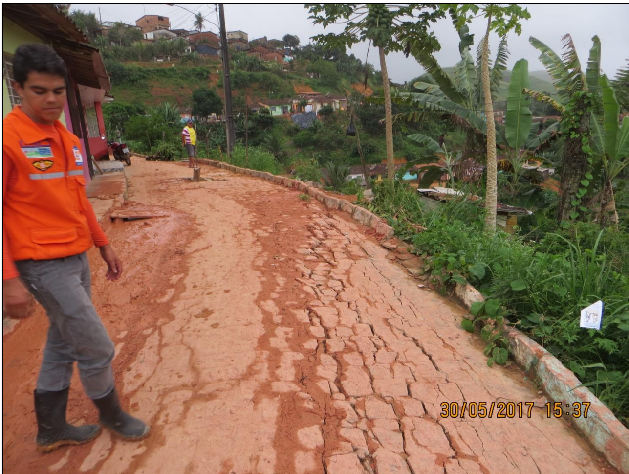
Foto 13: Fissuras no calçamento da rua do Matadouro, evidenciando processos ativos de Rastejo da encosta.
