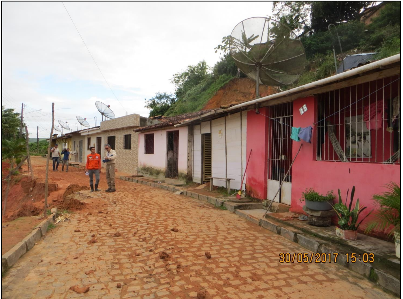
Foto 07: O calçamento da rua do Matadouro, parcialmente destruído por processos erosivos nas bordas do talude de corte no patamar abaixo da rua, após as chuvas de Maio de 2017.
