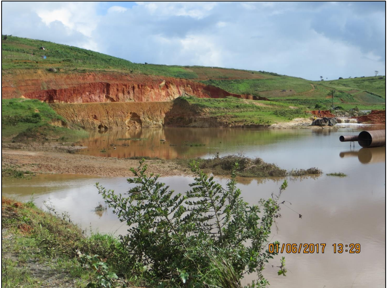
Foto 02: Barragem de Barra de Guabiraba, inacabada, rompida em três pontos, em virtude das chuvas de 05/2017. Observa-se no canto superior esquerdo da fotografia o fluxo contínuo da água do Rio Sirinhaém.
