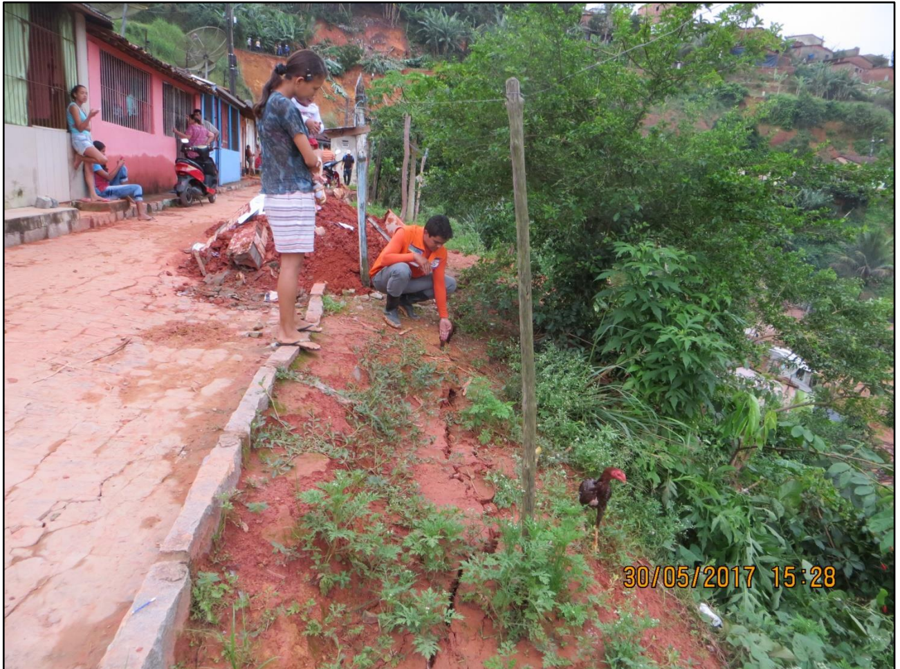
Foto 12: Rachadura com degrau de abatimento no solo do patamar de corte e aterro onde se localiza a rua do Matadouro, evidenciando processos ativos de Rastejo da encosta.
