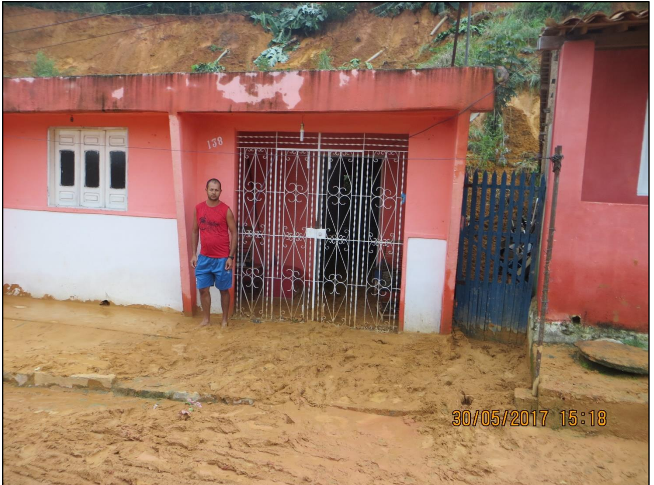
Foto 09: Registro de casa danificada por deslizamento planar de solo após as fortes chuvas de Maio/2017, na Rua do Matadouro (Rua Carlos José Soares), Cortez-PE.
