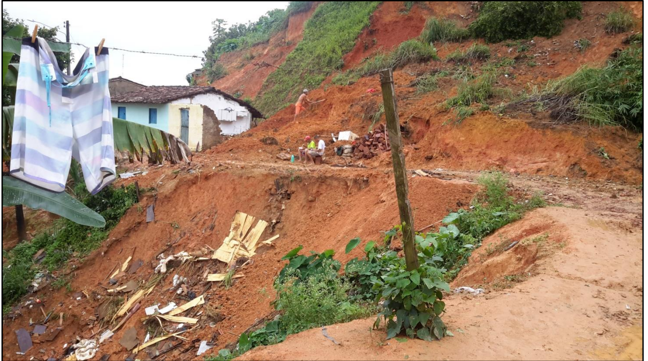
Foto 16: Parte final da encosta do Aparadouro, onde os processos de deslizamento planar exibem-se mais expostos devido à ausência de calçamento e drenagem por parte do poder público.
