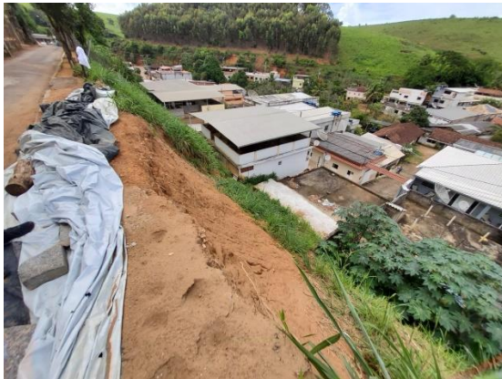
Figura 12. Local onde houve deslizamento em 2022
