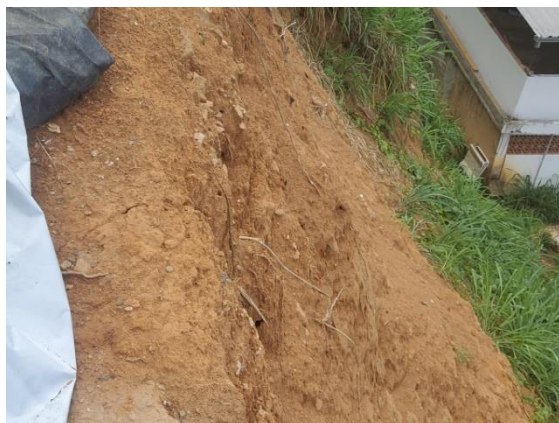
Figura 2. Indícios de movimentação em aterro na crista da encosta.
