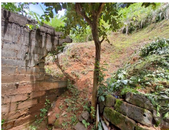
Figura 24. Muro parcialmente destruído em 2008.
