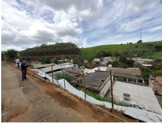
Figura 10. Vista para o setor a partir da Rua Balbina de Oliveira. Existe deslocamento da guia da rua.
