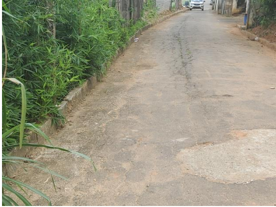
Figura 18. Abatimento na Rua Balbina de Oliveira
