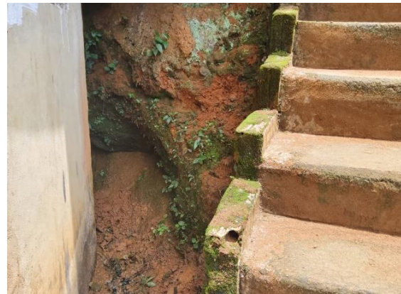
Figura 23. Surgência de água em fratura da rocha (plano 190/40).
