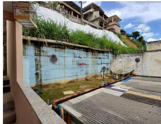
Figura 17. Muro (em patamares) sem drenagem
