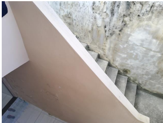
Figura 16. Muro sem drenagem com marcas de umidade
