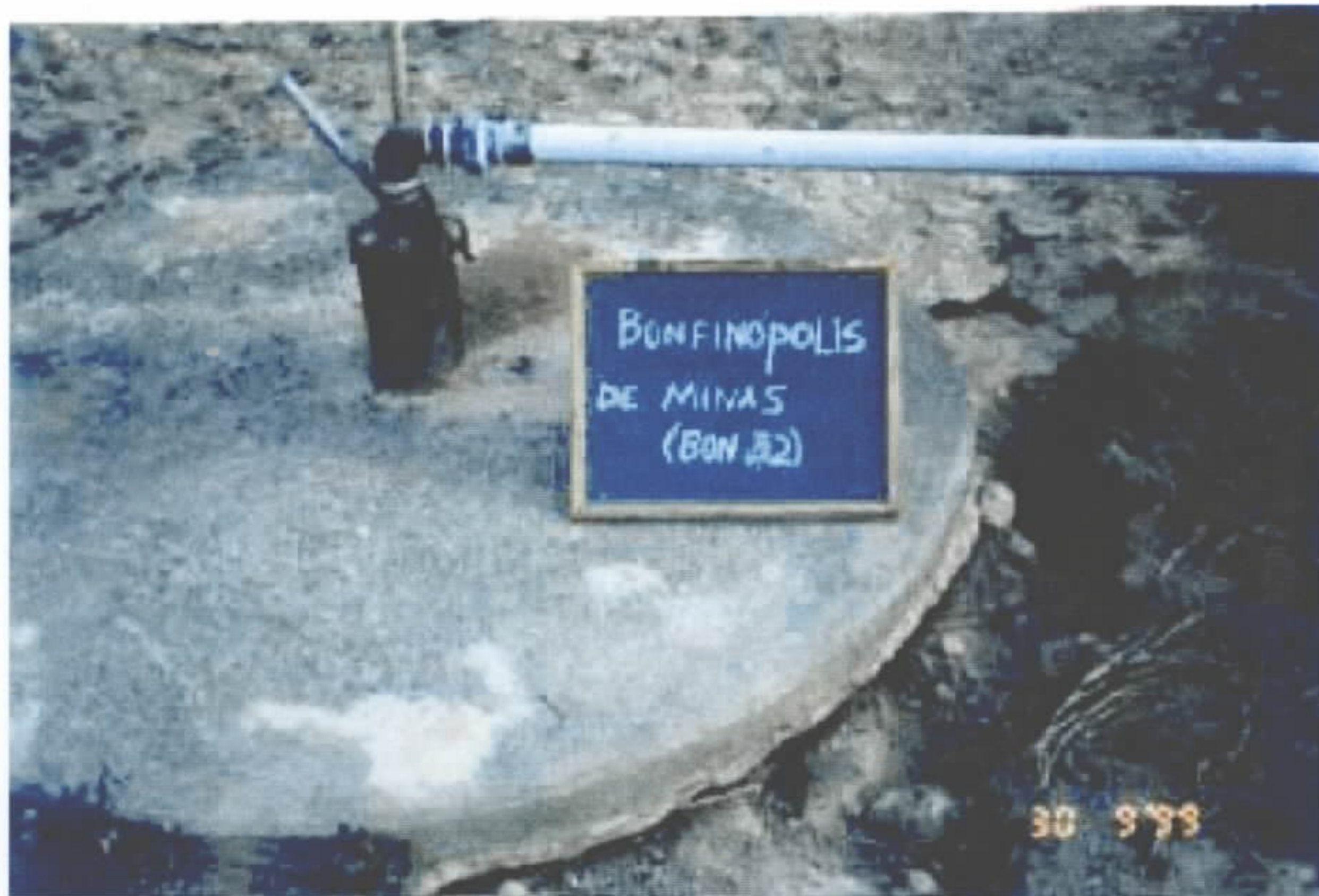
Foto 5 - Poço tubular produtivo, mostrando laje de proteção sanitária suspensa em decorrência da erosão do terreno ao redor (BON 32). Risco potencial de contaminação elevado. UTM: 371269E/8172487N.
