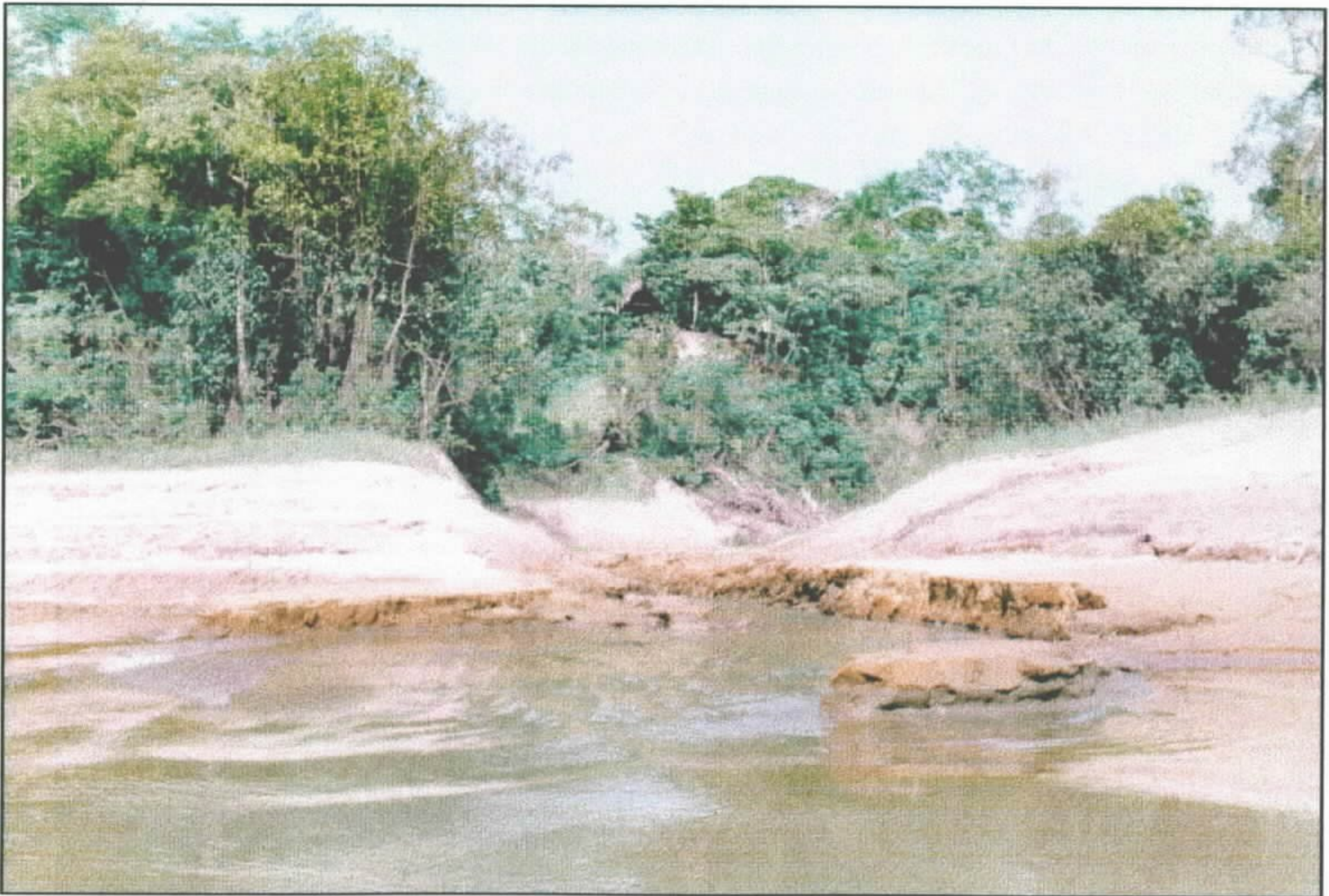
Foto 10 – Processo erosivo em Neossolo Flúvico, com rompimento de diques marginais de tributário do igarapé de Belém, após período de afogamento das cheias. Lat. 4^{\circ} 02' S e Long. 69^{\circ} 31' W .
