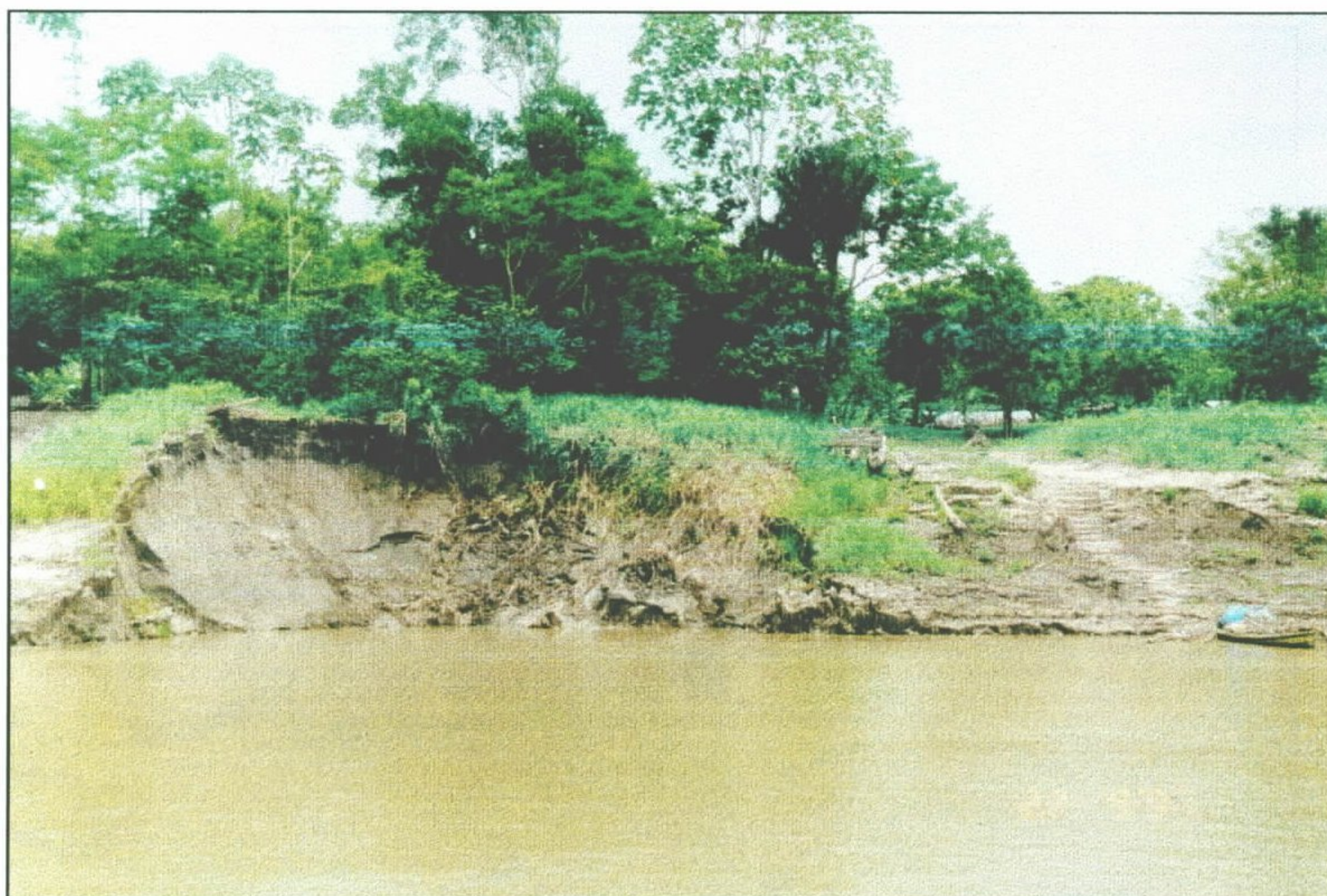
Foto 6 – Nas cercanias de Tabatinga (margem esquerda do rio Solimões), observa-se a potencialidade do risco existente para plantações e moradias, pela proximidade às evidências de erosão e retrocesso das margens.
