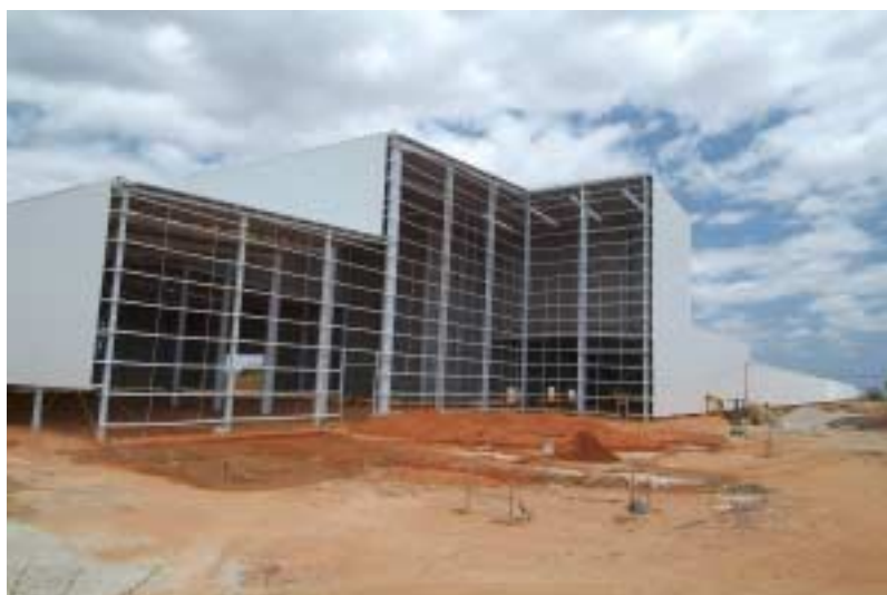
Foto 5.12 - Instalações físicas da empresa de cerâmica de revestimento (porcelanato) da Itagrés (Mossoró)
