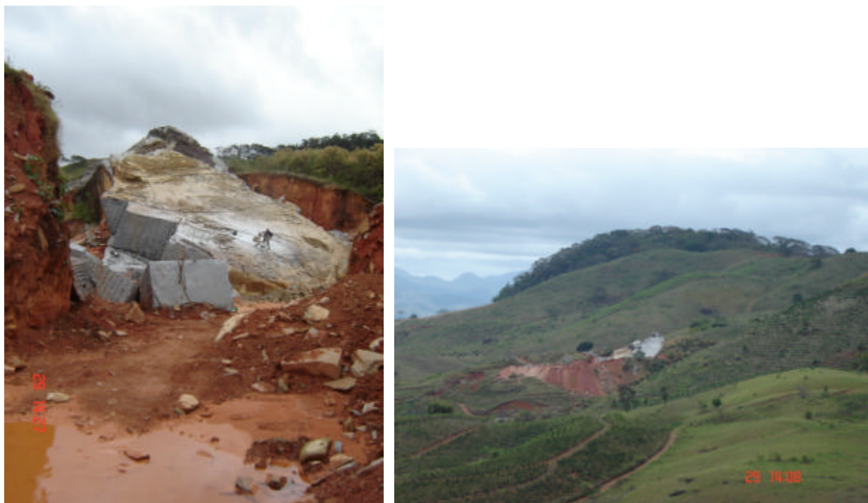
Figura 5.58: Pedreira no extremo sudeste da folha, já no Estado de Rio de Janeiro perto da divisa com o Estado de Minas Gerais.
