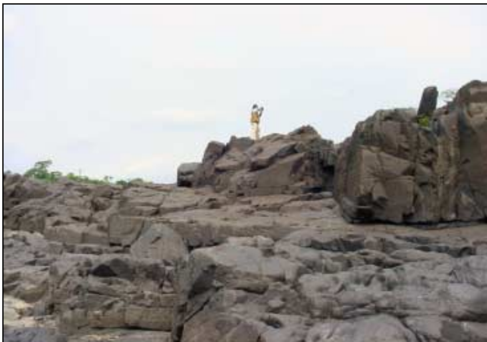
Figura 40 - Detalhe em afloramento do granito na Cachoeira do Jirau, mostrando intenso sistema de fraturas abertas.
