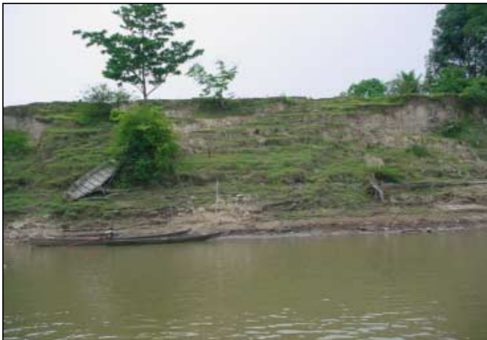
Figura 103 - Barranco da margem direita do rio Madeira (JG-102) constituído por sedimento siltico-argiloso em processo de dismantelamento e erosão. Área ocupada por fazenda de gado.
