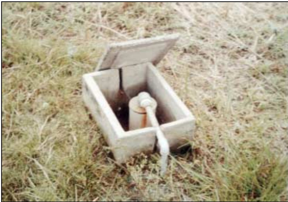
Figura 3.8 - Poço semi-artesiano responsável pelo abastecimento da Escola Bela Vista, localizado a cerca de 15 m de distância da fossa sanitária.
