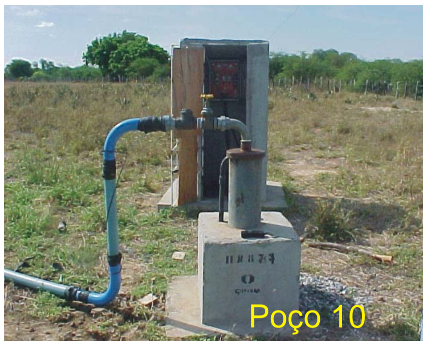
Foto 7.11. Poço nº 10, funcionando com bomba submersa instalada.
