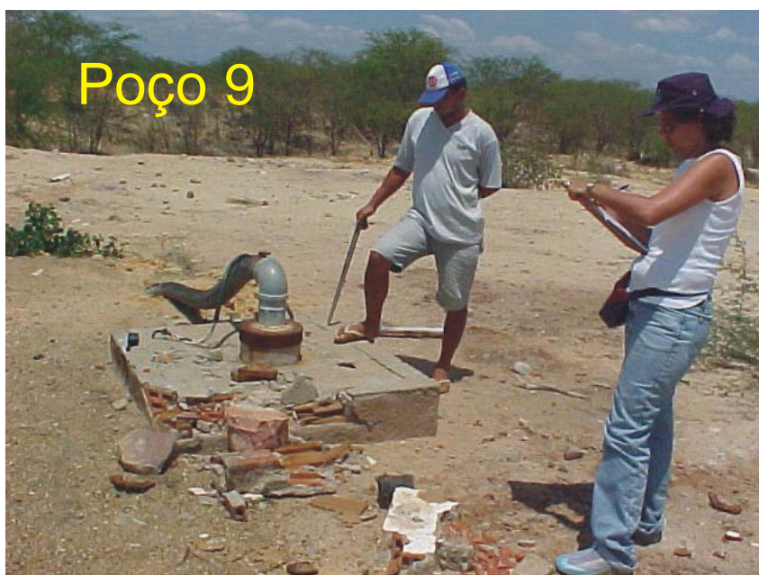
Foto 7.10. Poço nº 9, abandonado, sem casa de bomba nem energia.
