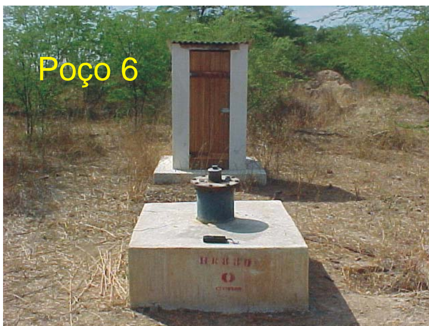
Foto 7.07. Poço nº 6, abandonado, possuindo casa de bomba sem energia elétrica.
