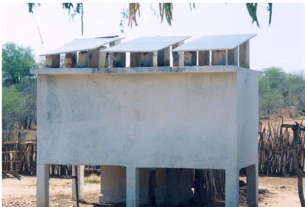
Foto 4.01. Placas sobre a caixa d'água destinadas à captação dos raios solares e transformação em energia para acionar a bomba
