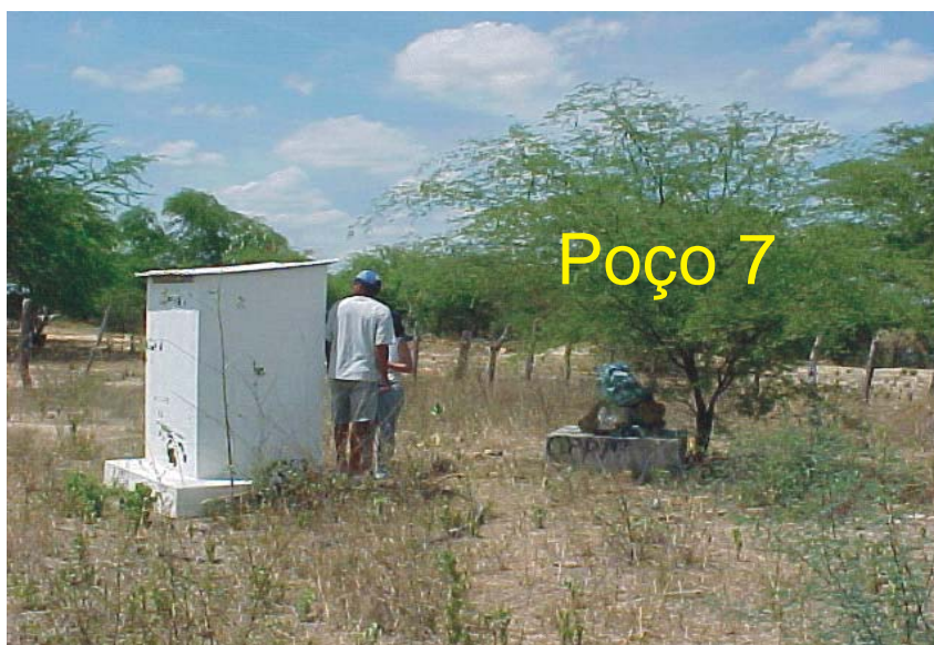
Foto 7.08. Poço nº 7, abandonado, com casa de bomba sem instalação elétrica.
