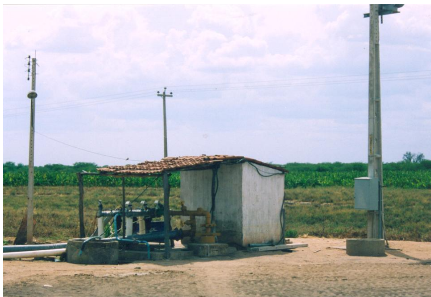
Foto 7.13. Poço tubular profundo instalado com bomba submersa e adutora para pivô central.
