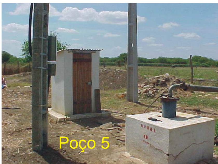
Foto 7.06. Poço nº 5, funcionando com bomba submersa instalada.
