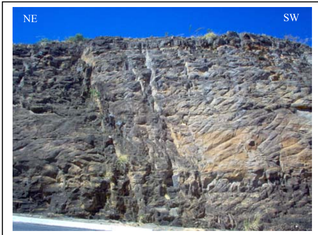
Foto 63 - Sistema de fraturas N60°W em arenitos da Fm. Serra das Araras na rodovia GO-362, parede sudoeste (RL-
