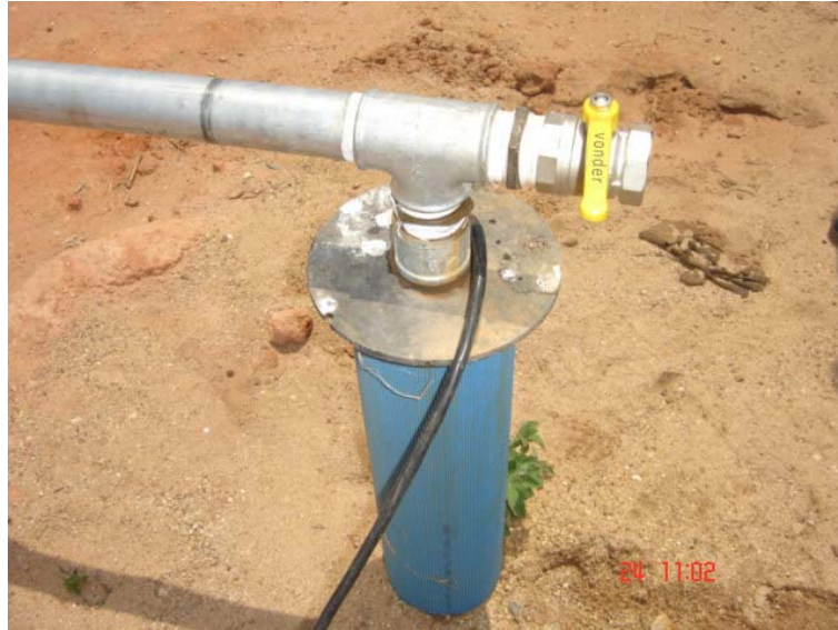
Foto 1.1. Poço tubular típico da área de trabalho (PT 110)
