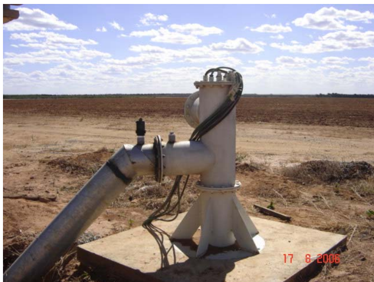
Foto 1.13 – Poço de bombeamento PT33 usado no teste de aquífero da Faz. COBA.
