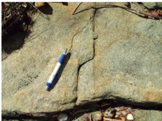
Foto 4.16 – Junta em “pull-a-part” em afloramento granítico no ponto MR 034. Atitude 350°Az/subvertical.
