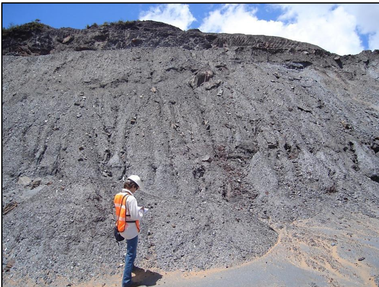
Figura 6.9 – Itabirito friável (RAM) com acumulação de material na base do talude.
