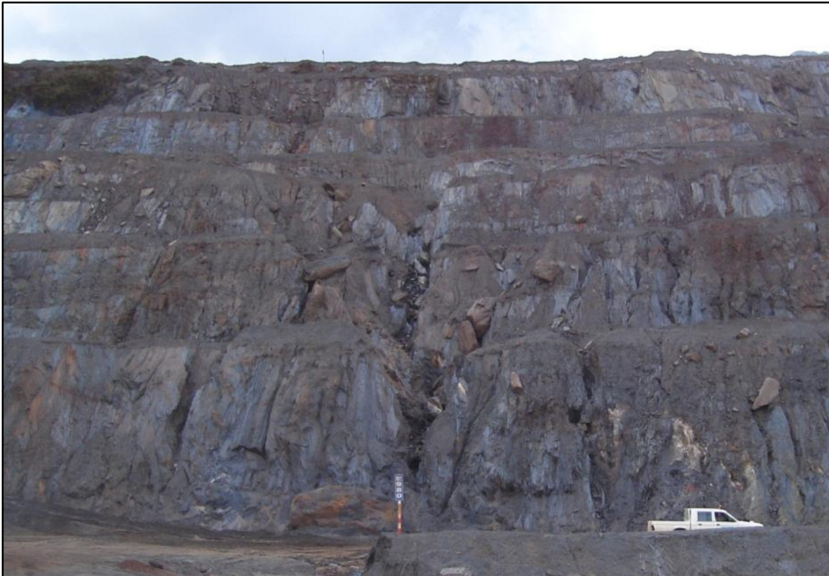
Figura 6.6 – Erosões na mina de São Luís afetando vários taludes.
