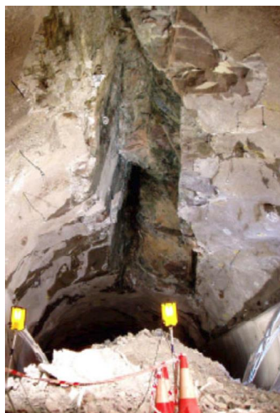
Figura 23 – Área do túnel Hanekleiv onde ocorreu queda de blocos. (Mao et al. , 2012).
