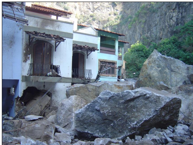
Figura 1 – Queda de blocos em Vila Isabel, bairro do município do Rio de Janeiro (Foto do autor).
