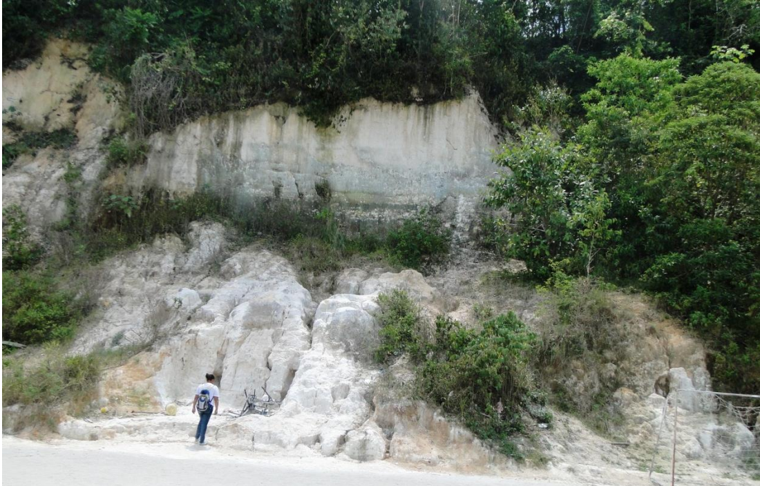
Figura 47 – Ponto Cn-01, feições erosivas aparentes na base da encosta. Foto do autor em 09/11/2012
