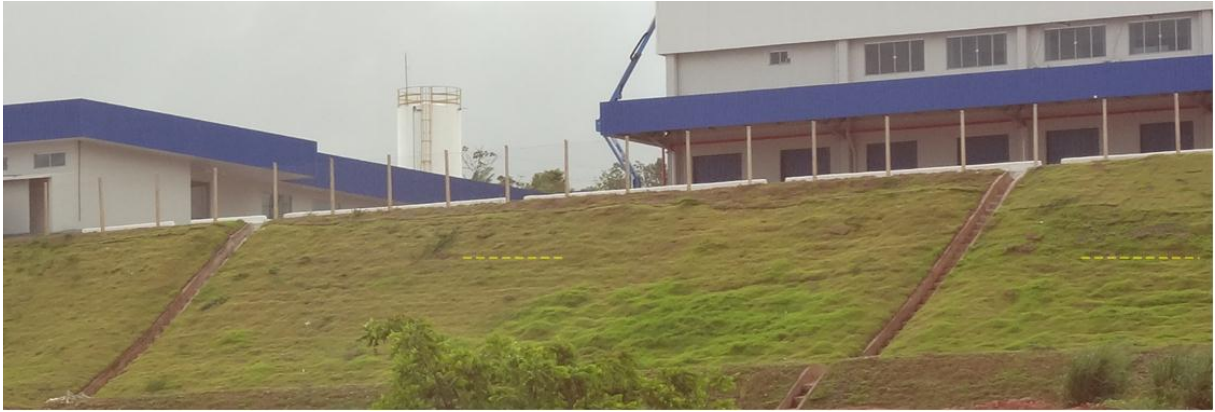
Figura 23. Na parte inferior da foto, é observável um deslizamento de solo na Formação Cabo (Kc).
