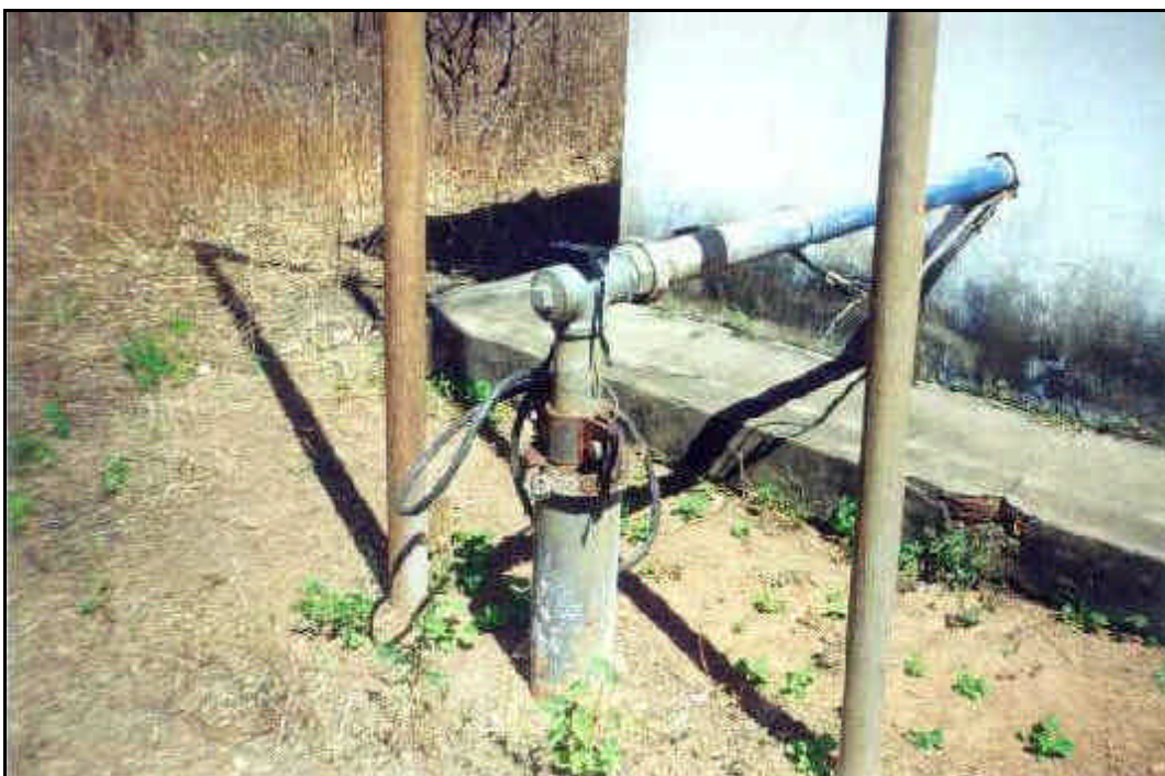
Figura 12.1 – Poço produtor da AGESPISA (AG012L), sem proteção sanitária
