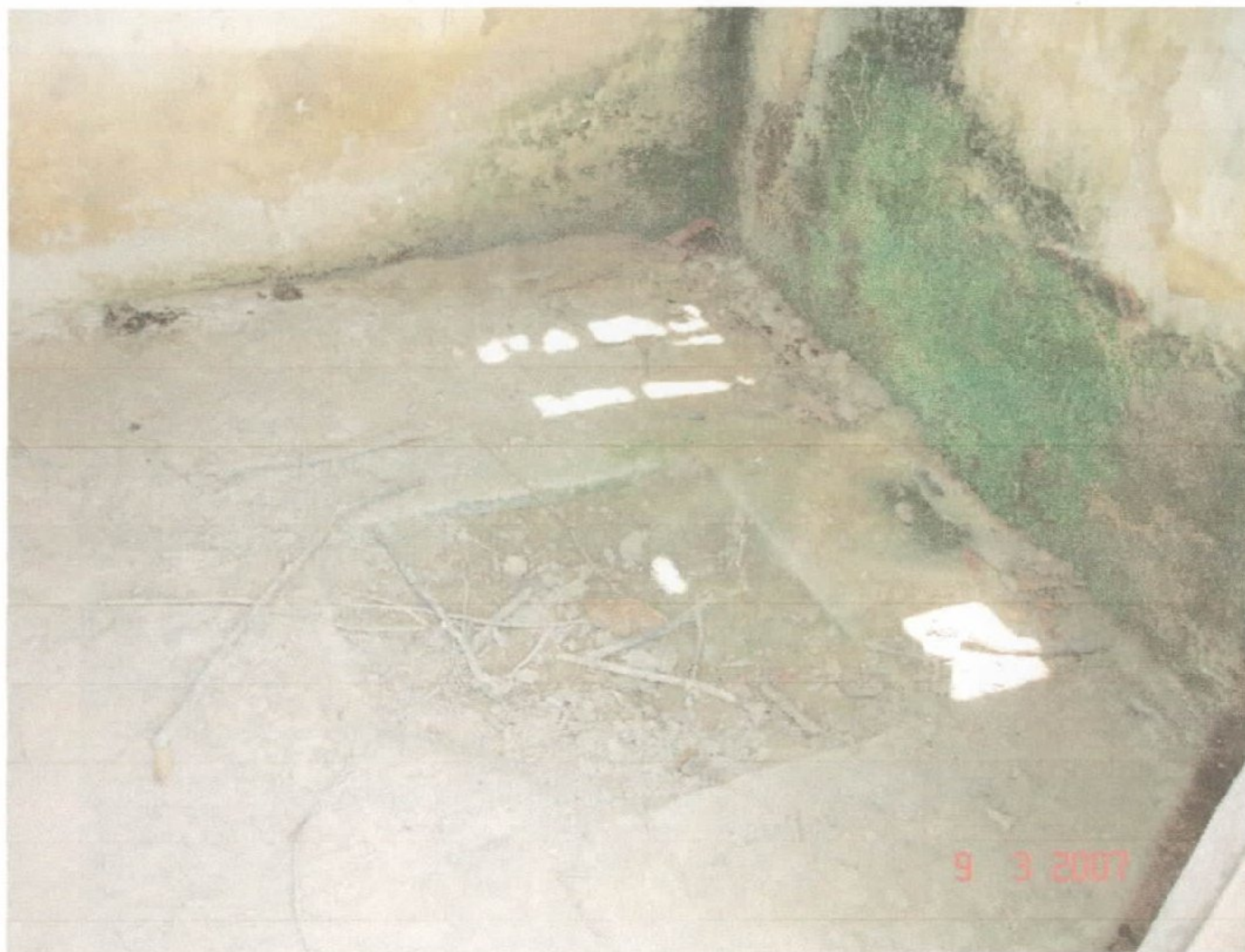
Vista da casa da bomba sem portas e destelhada.
