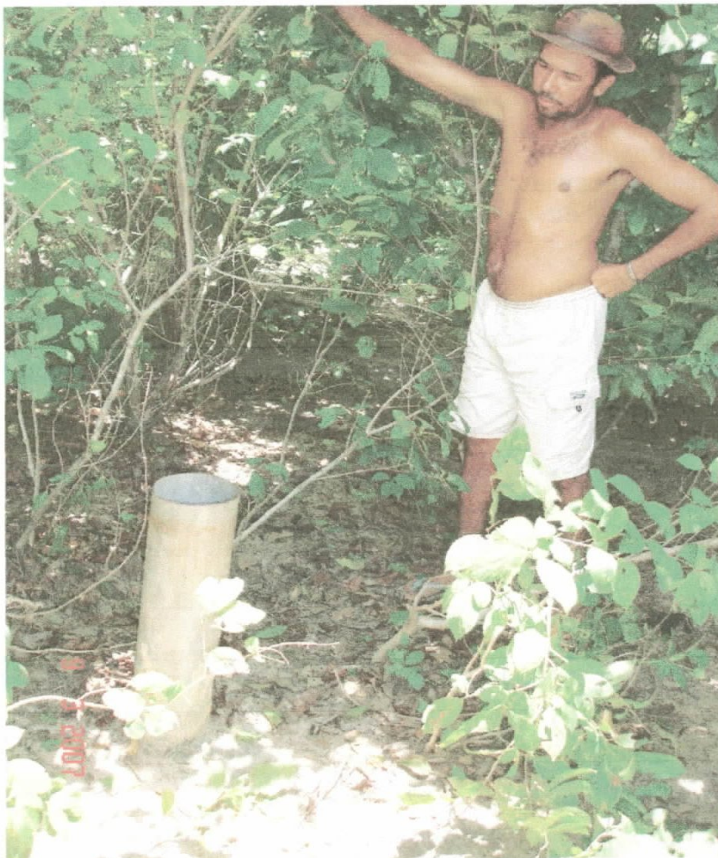
Vista do poço tubular sem a tampa, entupido e invadido pelo mato.
