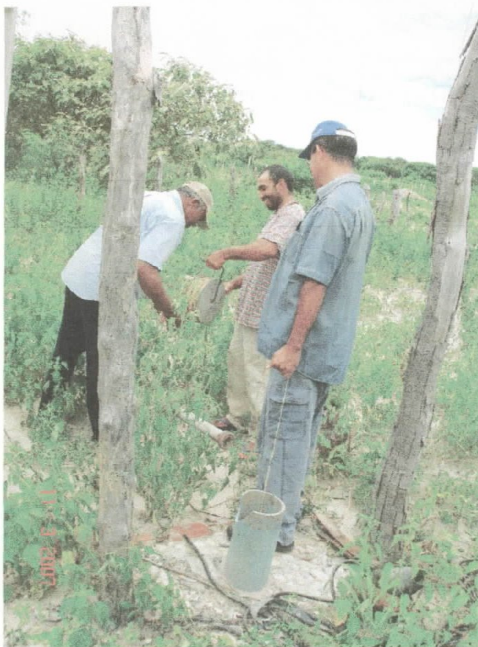
Unidade de captação com a boca do tubo de revestimento quebrada e sem a bomba submersa. Calibrando o equipamento para medir o Nível Estático.
