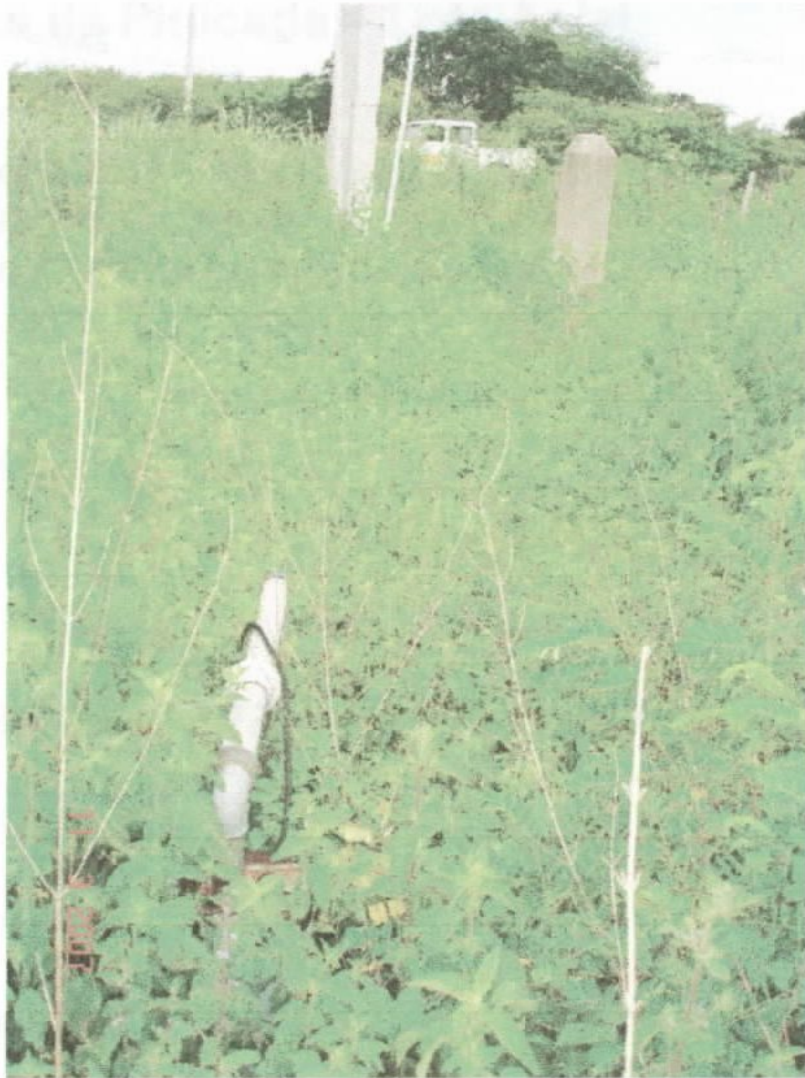
Vista da situação de abandono em que se encontra do Sistema Simplificado invadido pelo mato.
