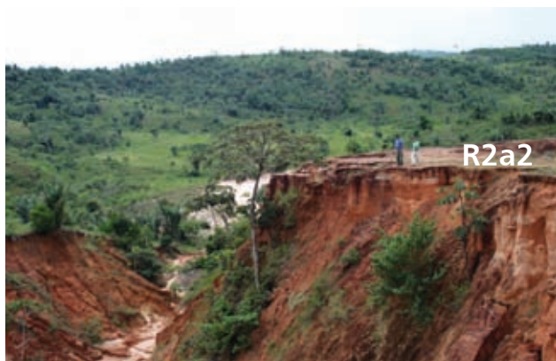
R2a2 – Tabuleiros dissecados, intensamente erodidos por processos de voçorocamento junto à rodovia Linha Verde (litoral norte do estado da Bahia).
