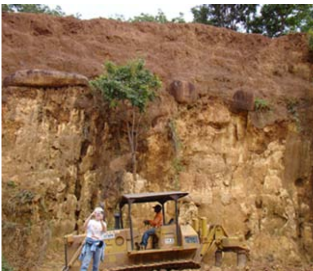
Figura 12.96 - Contato entre saprólito e blocos inalterados de rocha ígnea (base do talude) com rocha sedimentar argilosiltosa, de cor avermelhada (topo do talude), da unidade DSVMPaef. Rodovia BR-135, município Paraibano (MA).
