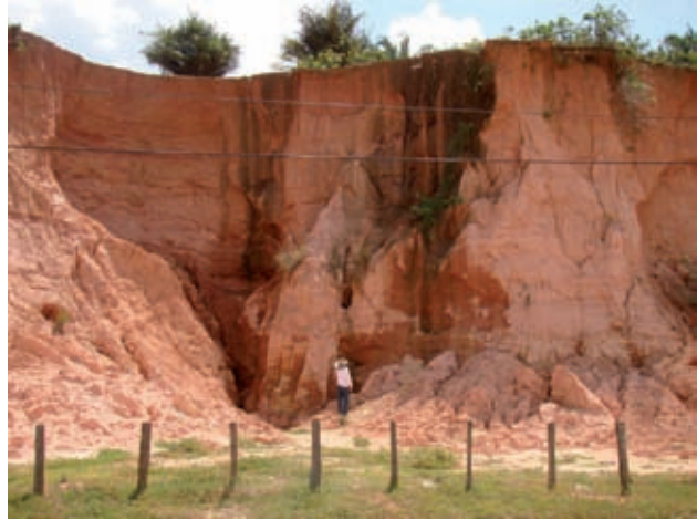
Figura 12.71 - Intercalações entre camadas arenosas e lâminas de argila muito instáveis em talude de corte, pouco coesas e predominantemente erodíveis. Rodovia MA-106, município Pinheiro (MA).
