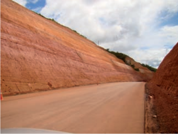
Figura 12.70 - Corte de estrada em rocha arenogilosa, com potencial erosivo e instável em talude de corte, devido à textura do material e à falta de cobertura vegetal. Rodovia BR-222, município Santa Luzia (MA).
