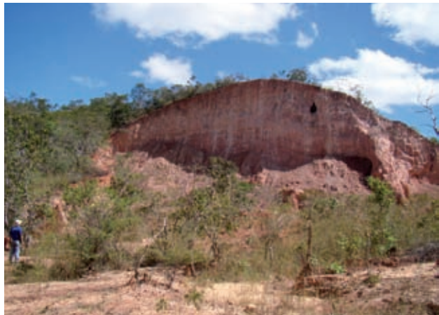
Figura 12.29 - Saprólito sedimentar muito erodível. Rodovia BR-230, município São Raimundo das Mangabeiras (MA).
