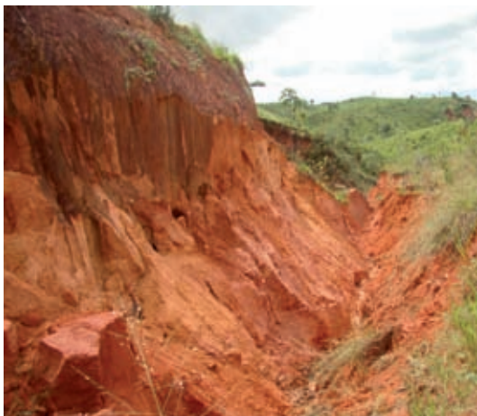
Figura 3.29 - Voçorocamento generalizado ao longo da rodovia BR-222; erosão linear e laminar acentuada em áreas de colinas e morros muito dissecados; solos e mantos de intemperismo do arenito Itapecuru apresentando alta vulnerabilidade à erosão. Rodovia BR-222, entre as localidades de Santa Luzia e Buriticupu.
