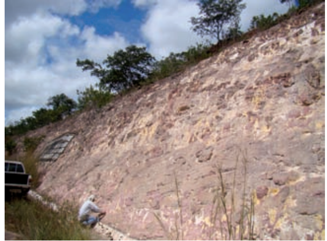
Figura 12.74 - Talude de corte em material sedimentar siltico-argiloso, muito intemperizado, com presença de caulinita e petroplintita, que favorecem a estabilidade no talude. Rodovia BR-230, município São Raimundo das Mangabeiras (MA).
