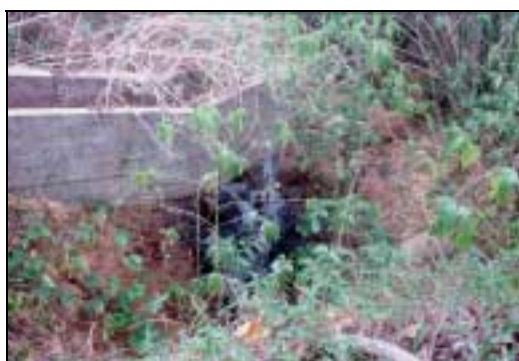
Foto 28 – Rompimento da calha dando início ao processo de erosão. Vila de Balbina
