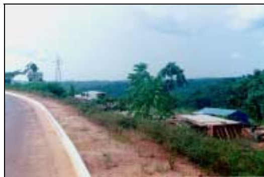
Foto 27 – Detalhe da área onde está sendo construído o novo sistema de esgoto. Vila Pitinga
