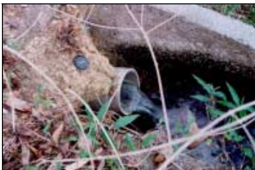
Foto 26 – Detalhe da rede de água servida escoando sem tratamento e poluindo as drenagens locais. Vila de Balbina
