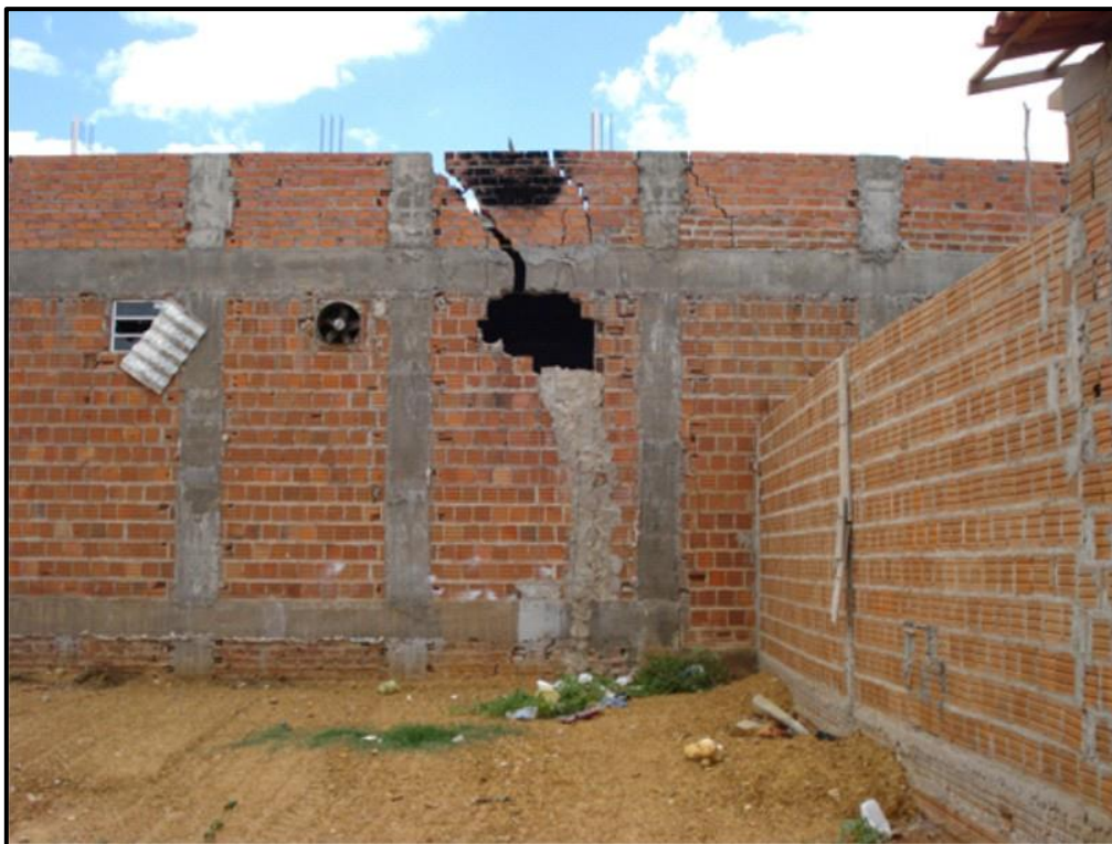
Fotografia 3 – Danos causados nas paredes de um mercado em construção na área de propagação da zona de deformação a partir da dolina da Fonte de Lapão.
