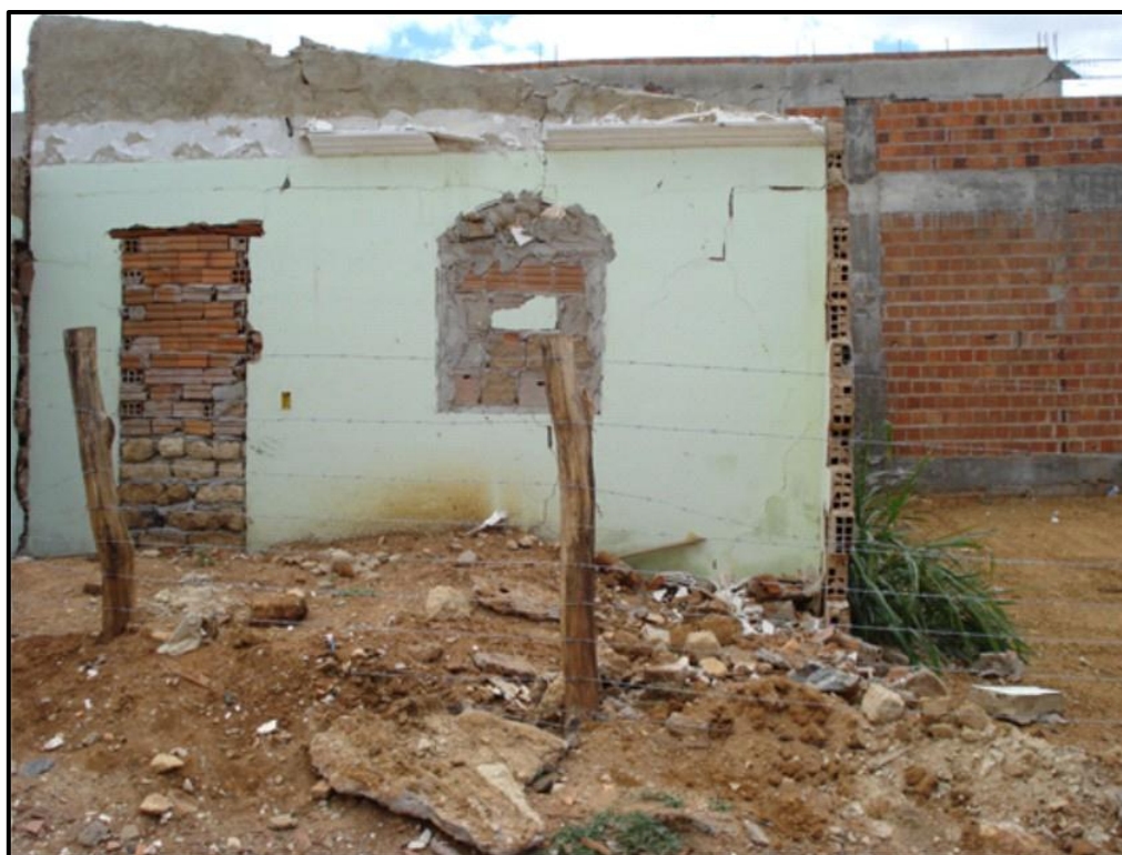
Fotografia 4 – Casa danificada na Rua José Marcelino na região de propagação da zona de deformação a partir da dolina da Fonte de Lapão.
