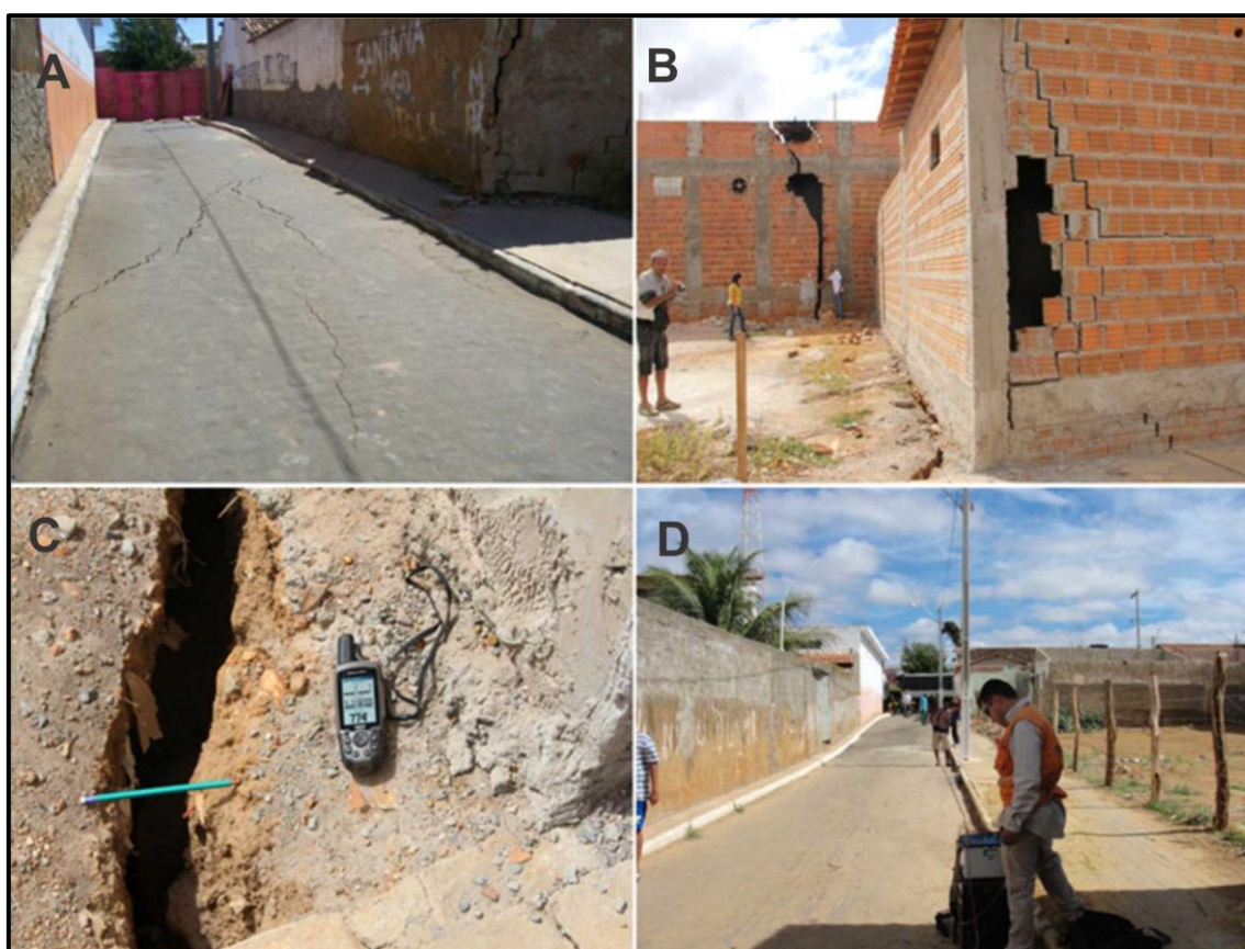
Prancha Fotográfica 4 – Situação das construções da Travessa Sócrates de Menezes, transversal a zona de deformação que se propagou a partir da Fonte de Lapão. A – Colapso e trincas no piso da travessa; B – Rupturas da parede de um mercado em construção; C – Fratura aberta; D – Levantamento geofísico ao longo da travessa.
