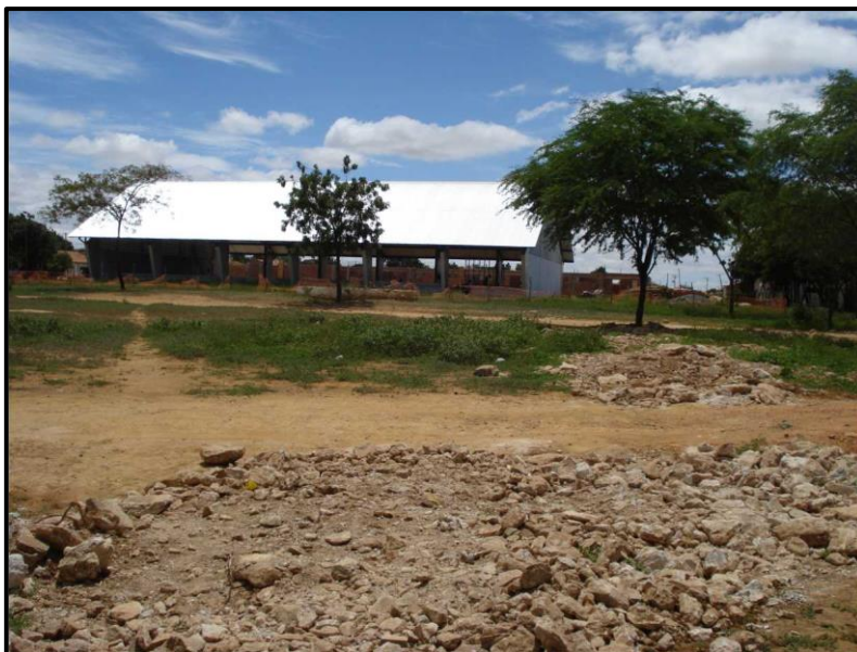
Fotografia 8 – Quadra esportiva em construção no Bairro Ida Cardoso. Na parte inferior da fotografia observam-se entulhos preenchendo uma fenda com direção N-S, formada recentemente.
