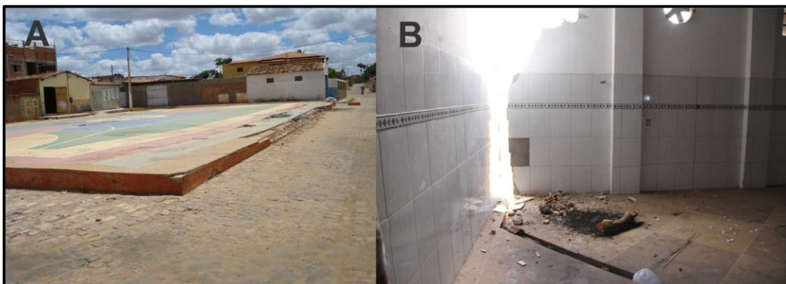
Prancha Fotográfica 3 – Danos causados pela propagação da zona de deformação a partir da dolina da Fonte de Lapão. A – Colapso na quadra esportiva construída adjacente a Praça da Fonte. No local em que a quadra foi construída já era conhecida uma cavidade que se conectava com a dolina; B – Vista interna dos danos causados nas paredes de um mercado em construção.
