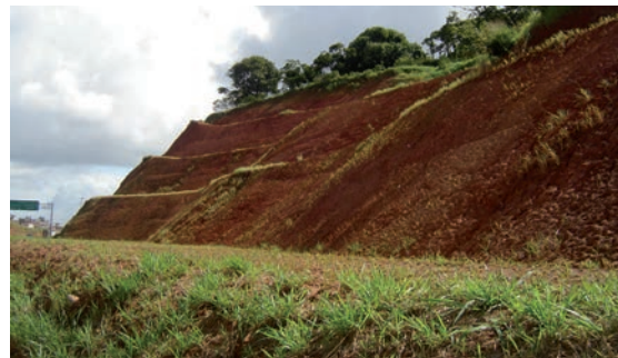
Figura 5.80 – Talude ao longo da Avenida Luis Eduardo; o embasamento na área apresenta-se alterado, conservando, porém, as estruturas reliquias rúpteis (Salvador, BA).
