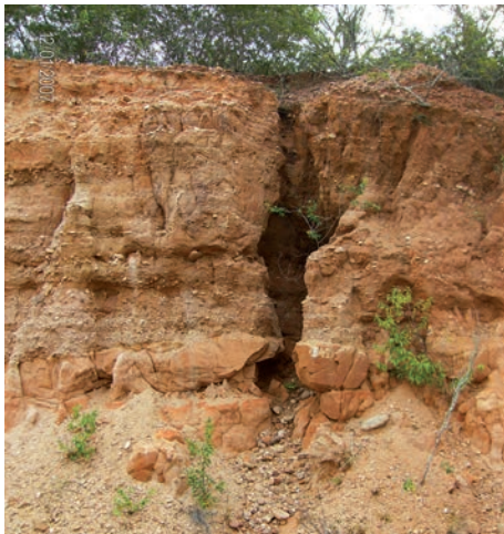
Figura 5.36 – Em litologias arenosas, processo erosivo (voçoroca) em corte de estrada da BR-110 (Sítio do Quinto, BA).
