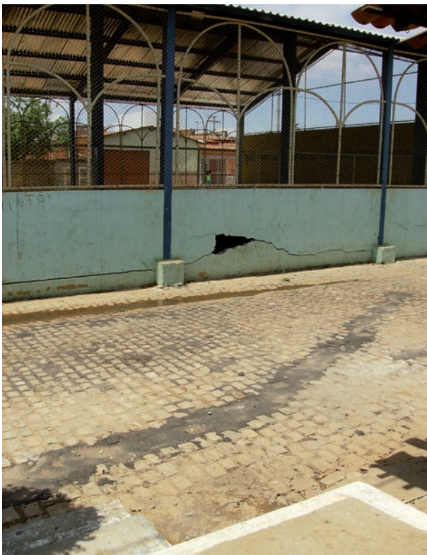
Figura 5.53 – Rachaduras no prédio do ginásio de esportes (Lapão, BA).
