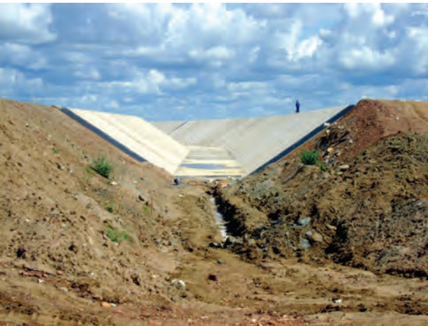
Foto 1.2 – Trecho parcialmente cimentado do canal que compõe o Eixo norte do “Projeto de integração do Rio São Francisco com as bacias hidrográficas do nordeste setentrional”
