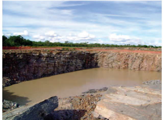
Foto 1.3 – Construção da Barragem do Tucutu no Eixo Norte do canal do “Projeto de integração do Rio São Francisco com as bacias hidrográficas do nordeste setentrional”
