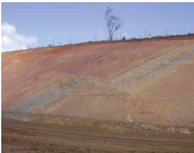
Figura 6.3 – Pequena falha distensiva afetando camada de FFB, descida da serra de Santo Antônio, rumo oeste
