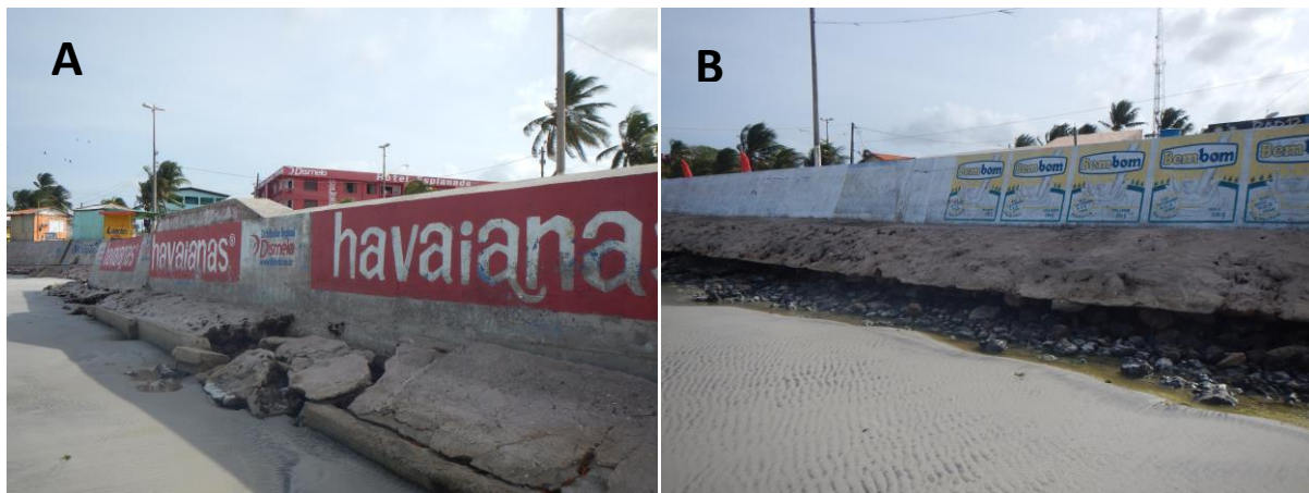
Figura 30- (A) Indícios do intenso processo erosivo, destruição de cordão de enrocamento na orla de Marudá em 2017. (B) Descalçamento de cordão através da remobilização de material, na orla de Marudá em 2017.
