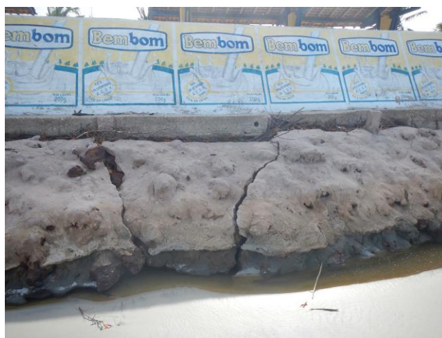
Figura 55- Fissuras no cordão de enrocamento, destruição e descalçamento de obra na praia de Marudá
