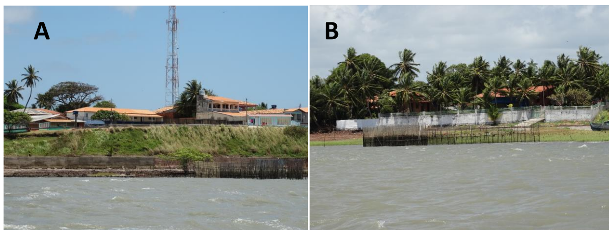
Figura 56- (A) Muro de arrimo demonstra bom estado, na praia de Marudá. (B) Muro particular com furos de drenagem da água.
