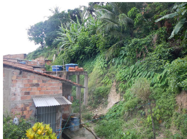
Figura 3.88: Casa de alvenaria construída muito próxima ao talude de corte de 90° de inclinação e que apresenta alta suscetibilidade a processos de deslizamento. Rua da Mangueira, município de São Luís – MA. Foto: Arquivo do Projeto Geodiversidade da Ilha do Maranhão (2018).
