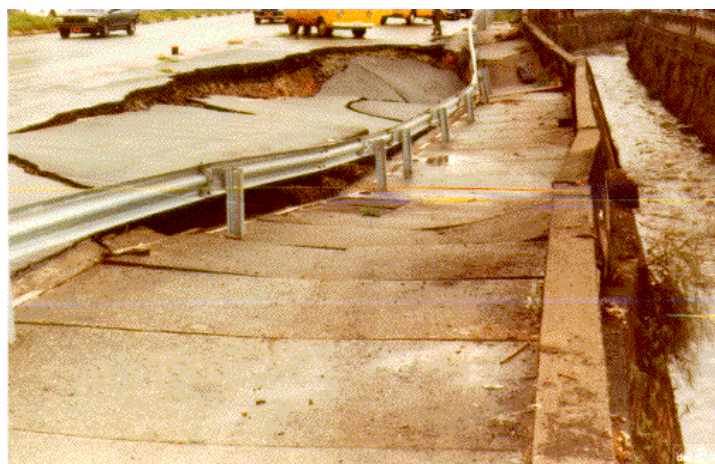
Figura 59 - Solapamento de margem do canal do córrego Ipiranga ocasionando interdição parcial da Av. Ricardo Jafet, São Paulo. Problemas envolvendo obras inadequadas de engenharia executadas com o objetivo de permitir a ocupação da planície de inundação através da canalização de córregos no município de São Paulo.
