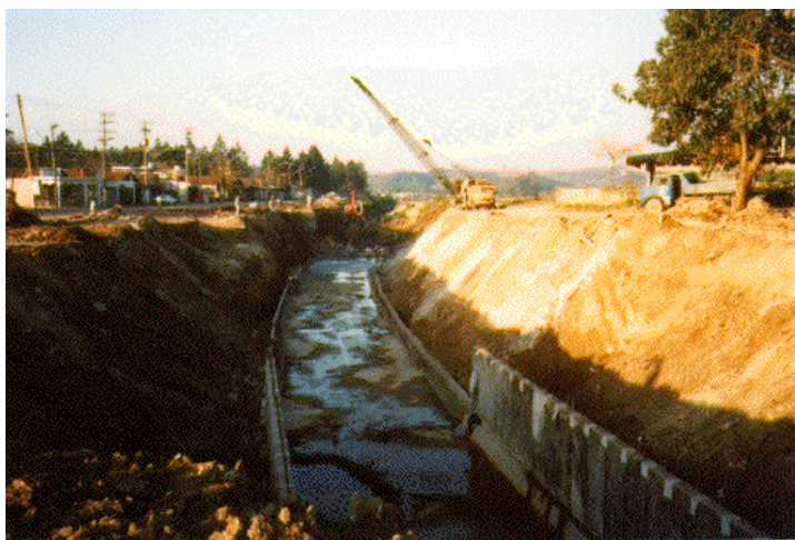
Figura 57 - Obra de canalização do córrego Água Vermelha, zona Leste de São Paulo, próximo à confluência com o rio Tietê, em área de potencialidade alta de ocorrências de inundação. As obras de canalização têm sido utilizadas na região metropolitana para o combate às enchentes, favorecendo a ocupação da planície de inundação.
