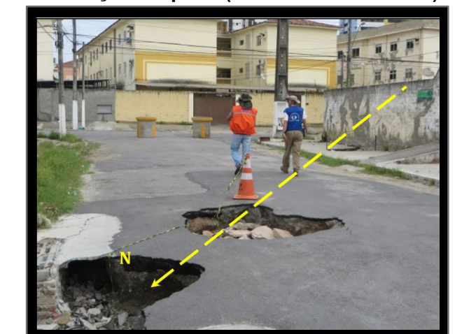
Máximo de feições rúptis (trincas e rachaduras)
