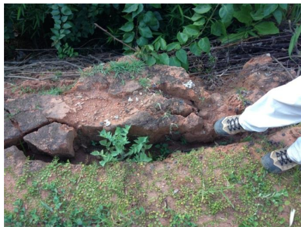
Figura 42: Trincas que surgiram no terreno após o último evento chuvoso.
