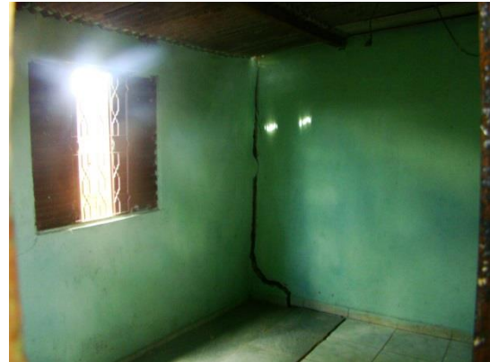
Figura 73: Rachaduras no interior de casa.
