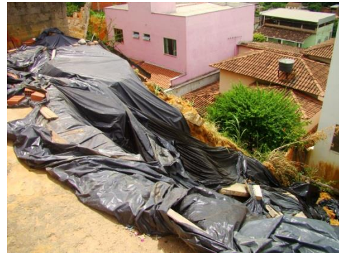
Figura 76: Deslizamento de solo.
