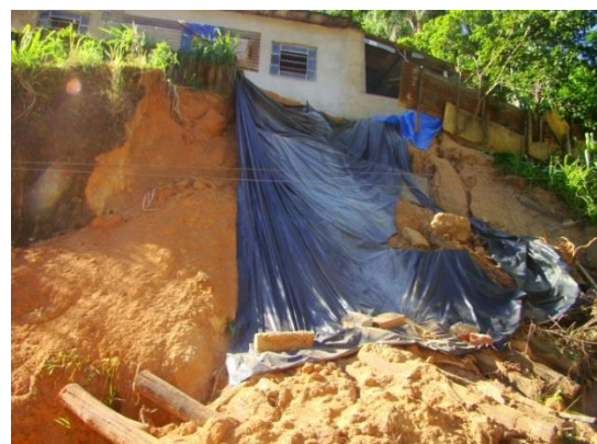
Figura 37: Deslizamento de solo que afetou parcialmente a residência.
