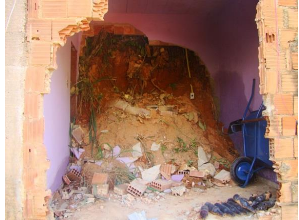
Figura 8: Deslizamento planar de solo que destruiu parcialmente a construção.
