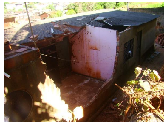
Figura 34: Destruição parcial de construção devido ao deslizamento translacional.
