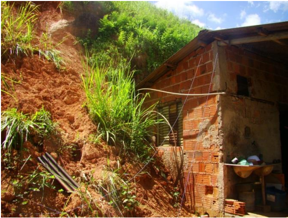
Figura 18: Deslizamento de terra que atingiu a residência.
