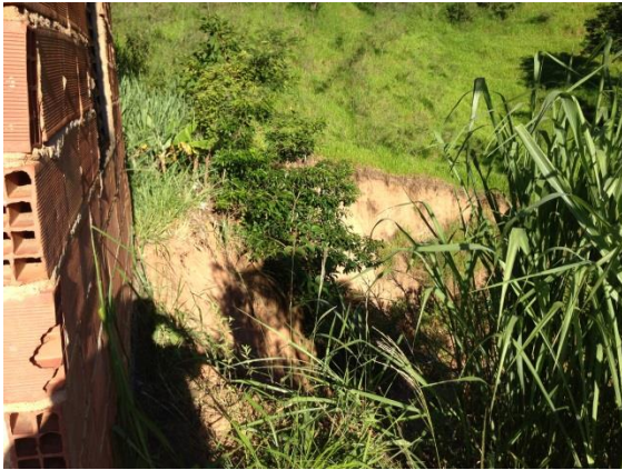
Figura 30: Risco de desabamento da construção
