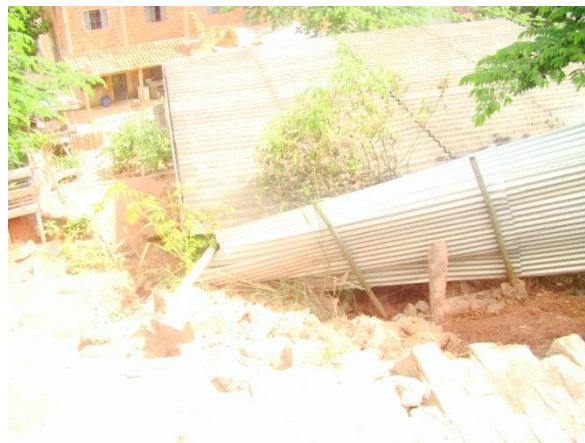
Figura 56: Deslizamento de terra que provocou remoção parcial da Rua Francisco Alves.
