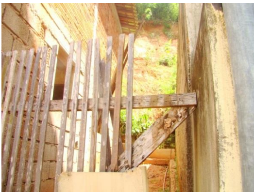
Figura 61: Deslizamento de terra que atingiu a moradia.
