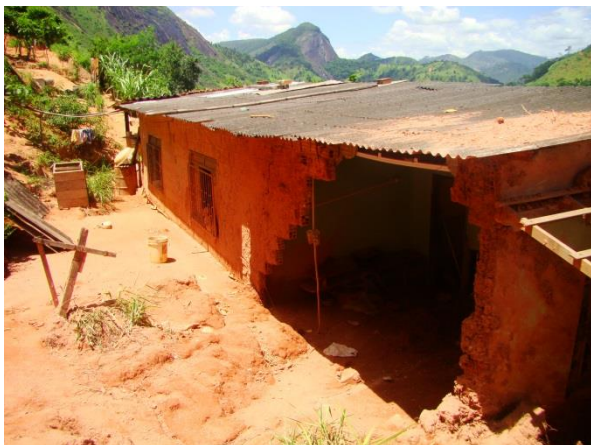
Figura 20: Deslizamento de terra que destruiu parcialmente a moradia.
