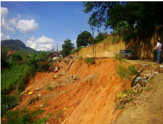
Figura 2: Deslizamento planar em parte da estrada.
