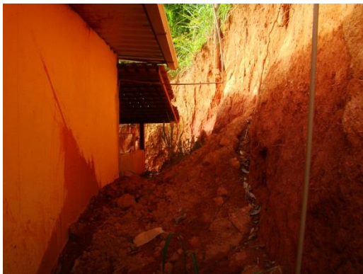
Figura 44: Deslizamento planar de solo que atingiu a construção.
