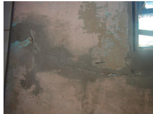
Figura 3: Trincas na parede de residência.
