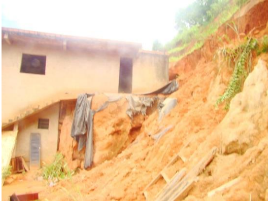
Figura 50: Deslizamento de solo que atingiu a construção.
