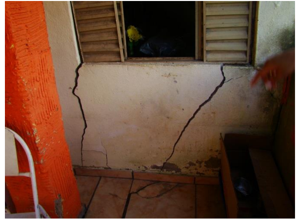
Figura 19: Rachaduras na parede e piso da construção.
