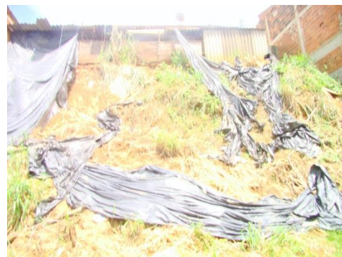
Figura 59: Deslizamento de solo.
