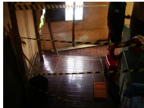
Figura 68: Afundamento de piso e aparecimento de rachaduras em paredes de residência.
