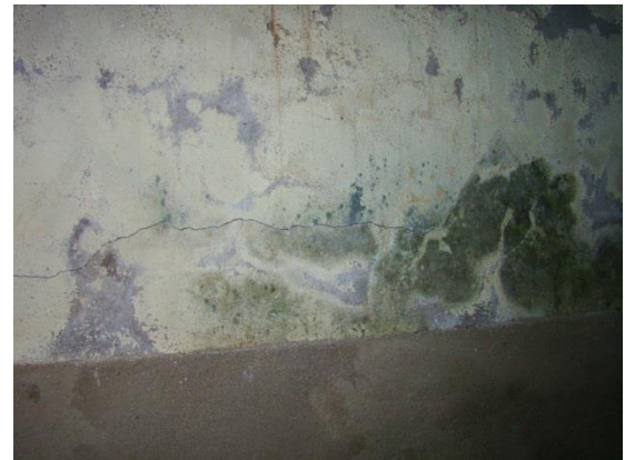
Figura 53: Trincas em parede de casa.
