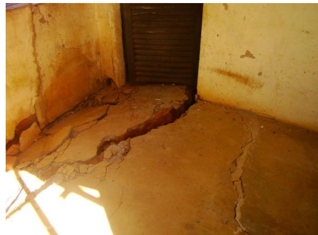
Figura 24: Grandes rachaduras na residência.
