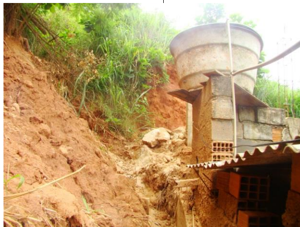
Figura 54: Deslizamento de solo que destruiu parcialmente a moradia.
