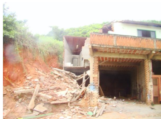
Figura 65: Destruição de parte da construção provocada por deslizamento.
