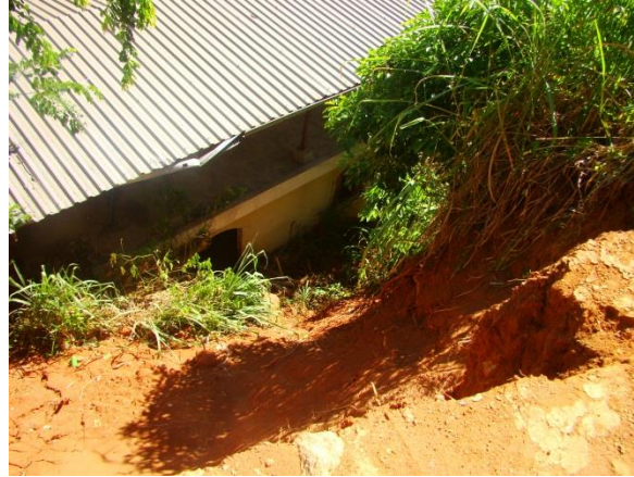
Figura 29: Casa atingida por deslizamento de solo e queda de blocos.
