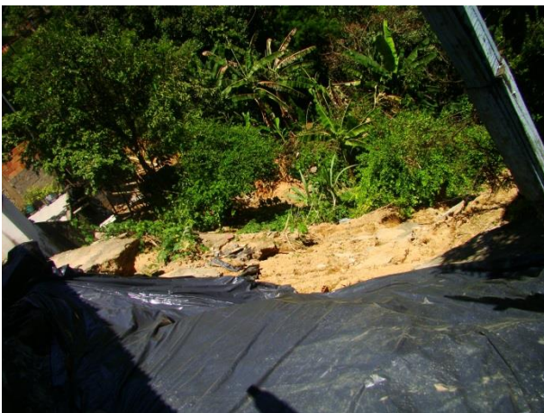
Figura 23: Deslizamento de terra que afetou parte da construção.
