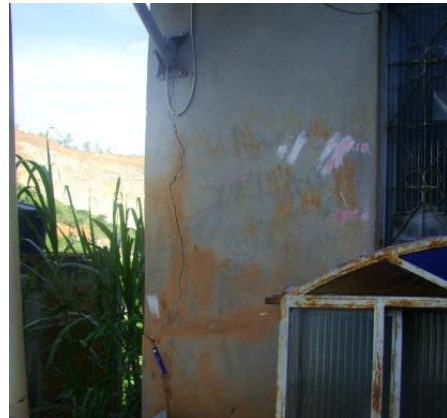
Figura 10: Rachadura na parede da residência.
