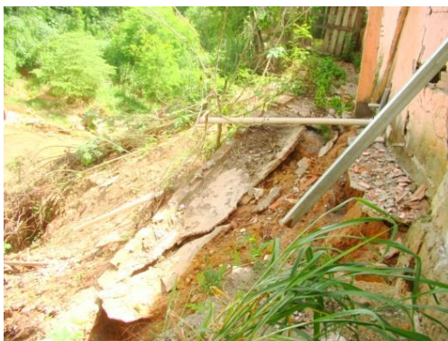
Figura 58: Solapamento de solo em uma das margens de rio.
