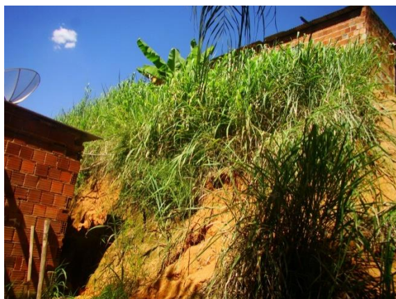
Figura 26: Área propensa a deslizamento de terra.
