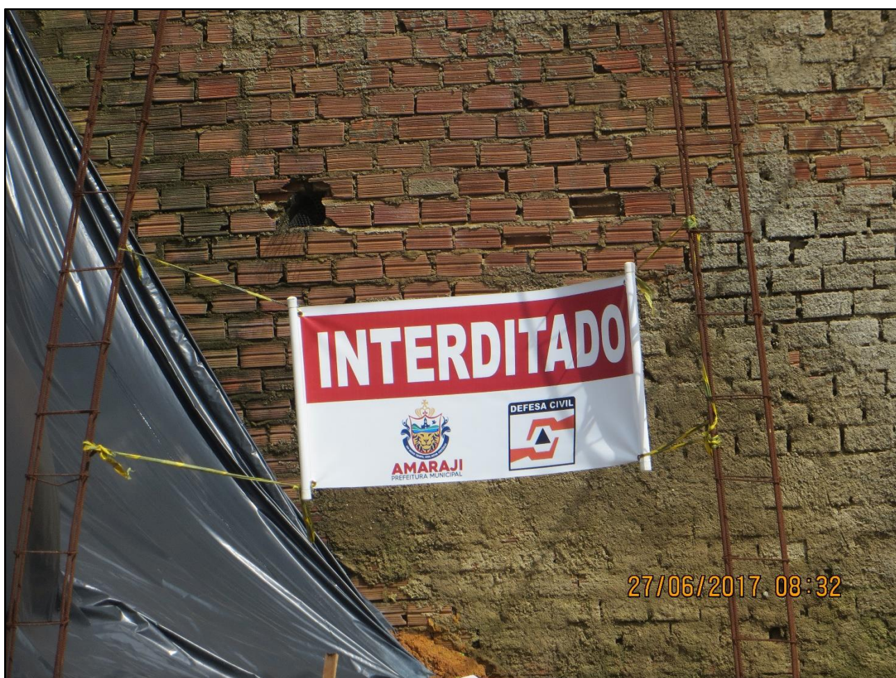
Foto 06: Encosta interditada pela Defesa Civil de Amaraji-PE, em razão de intervenções (cortes) irregulares feitas pelos próprios moradores, sem supervisão técnica adequada.
