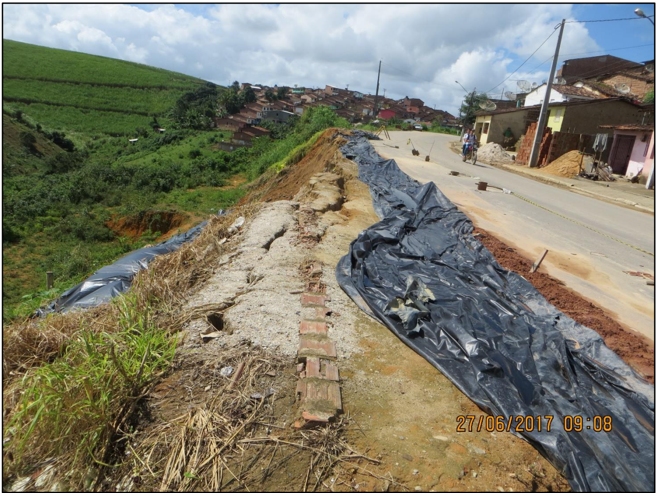
Foto 15: Rodovia PE-063, com problemas de erosão e deslizamento planar, foram colocadas lonas plásticas como proteção provisória, mas a situação exige uma vistoria técnicas por parte de engenheiros civis geotécnicos, que determinem uma solução mais adequada e definitiva.
