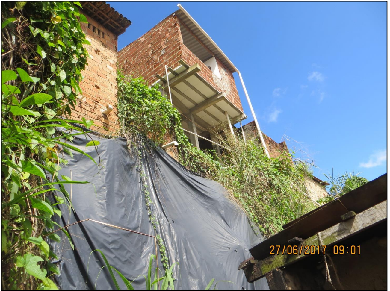
Foto 10: Casa construída muito próxima à crista de talude de corte subvertical, sem respeitar a distância mínima de segurança recomendada na literatura.
