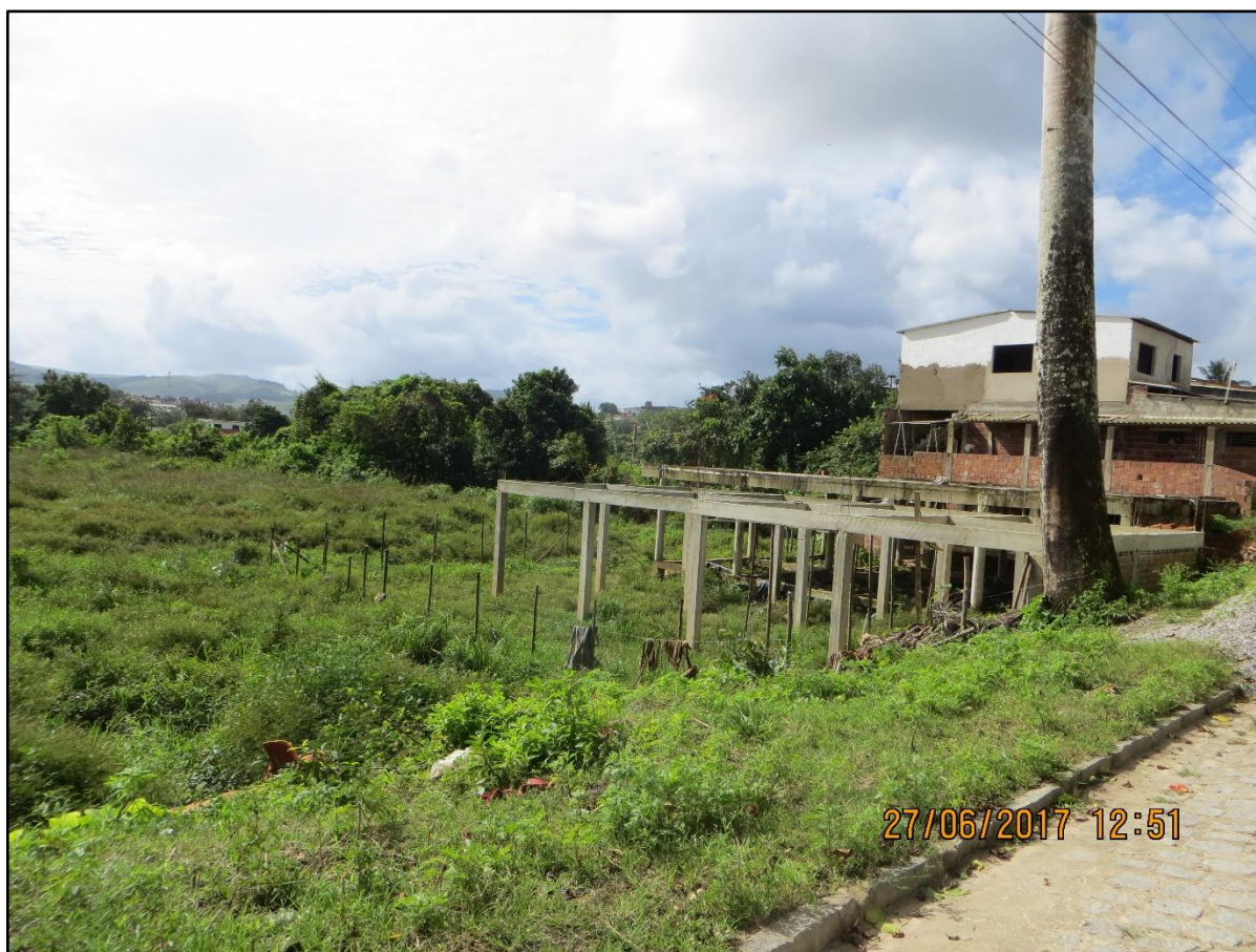
Foto 01: Casas com as fundações construídas dentro do leito de inundação do Rio Amaraji, na Rua Duque de Caxias (Rua d'Água).
