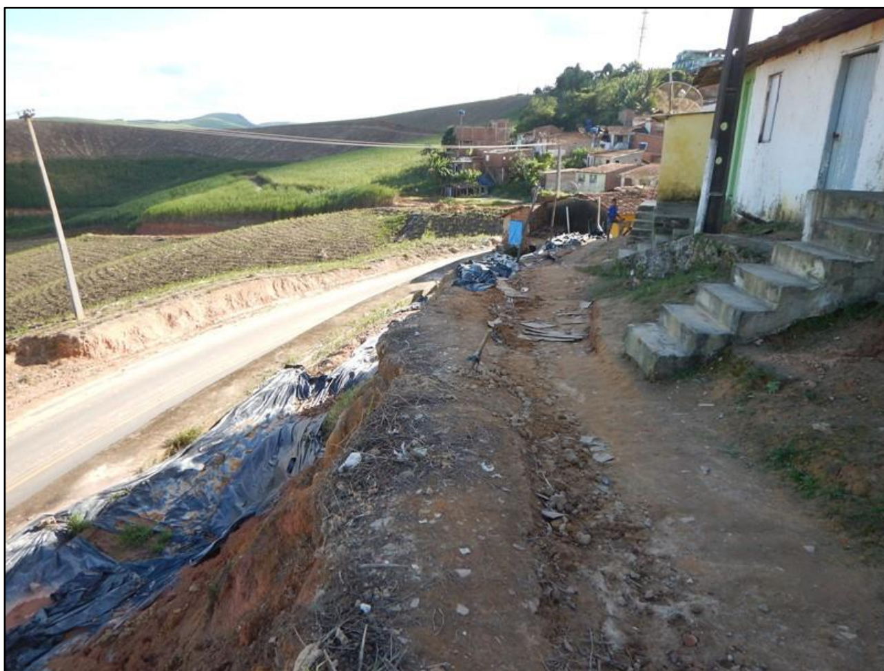
Foto 18: Casas construídas próximas à crista do talude às margens da rodovia PE-063, em risco de deslizamento, com lonas plásticas colocadas como proteção provisória e um rego escavado de modo informal, para servir de escoamento às águas pluviais e minimizar os riscos de deslizamentos.
