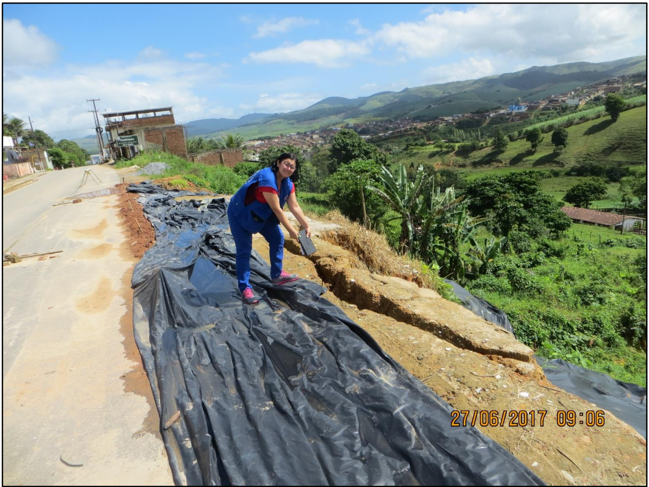
Foto 14: Rodovia PE-063, com problemas de erosão e deslizamento planar, foram colocadas lonas plásticas como proteção provisória, mas a situação exige uma vistoria técnicas por parte de engenheiros civis geotécnicos, que determinem uma solução mais adequada e definitiva.
