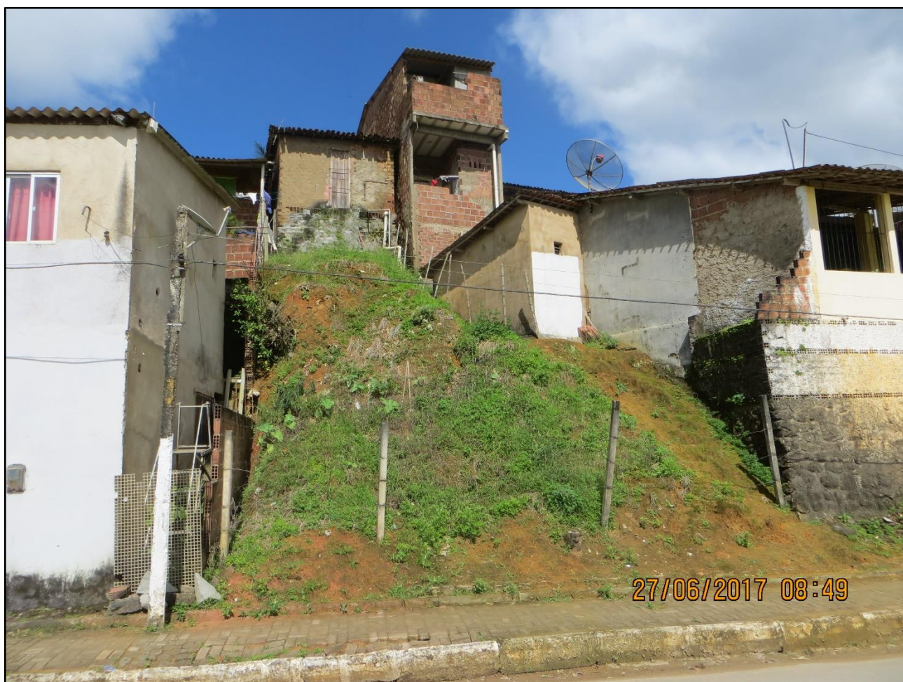
Foto 08: Moradia construída muito próxima à crista do talude, sem respeitar a distância mínima de segurança recomendada na literatura. Adicionalmente, construção de segundo piso acrescenta peso à construção e aumenta a instabilidade da situação.
