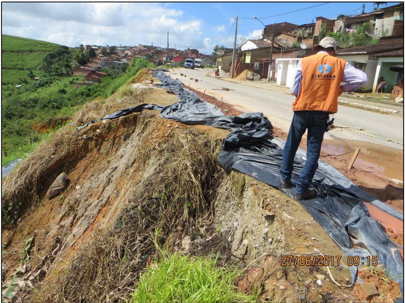
Foto 16: Rodovia PE-063, com problemas de erosão e deslizamento planar, foram colocadas lonas plásticas como proteção provisória, mas a situação exige uma vistoria técnicas por parte de engenheiros civis geotécnicos, que determinem uma solução mais adequada e definitiva.
