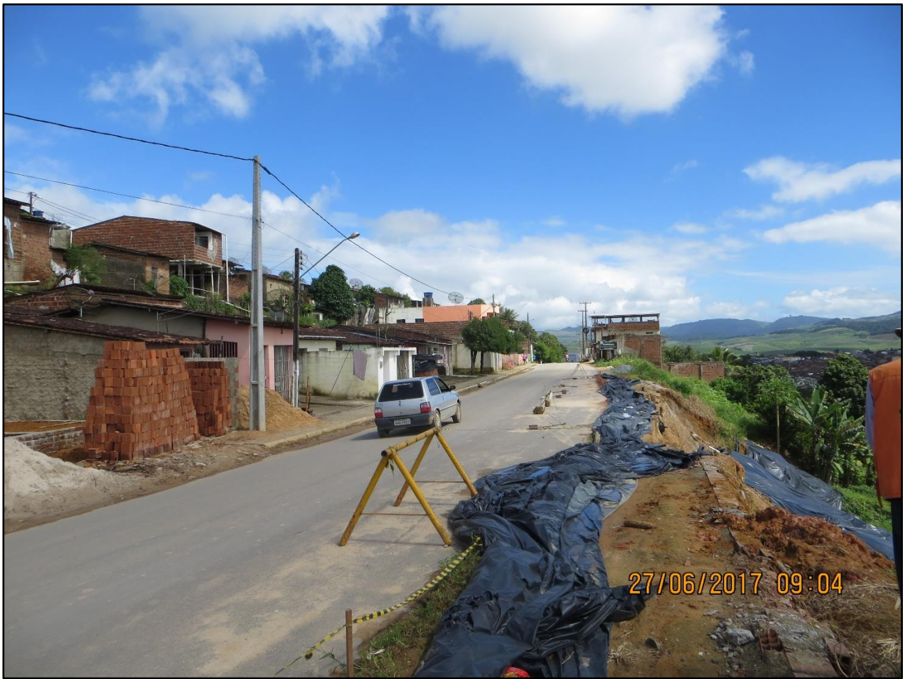
Foto 13: Rodovia PE-063, com problemas de erosão e deslizamento planar, foram colocadas lonas plásticas como proteção provisória, mas a situação exige uma vistoria técnicas por parte de engenheiros civis geotécnicos, que determinem uma solução mais adequada e definitiva.
