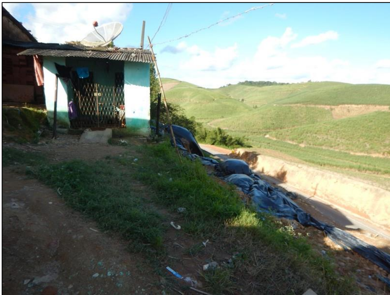
Foto 20: Casa construída muito próxima à crista do talude de corte às margens da rodovia PE-063. Lonas plásticas foram instaladas no talude, como proteção provisória.
