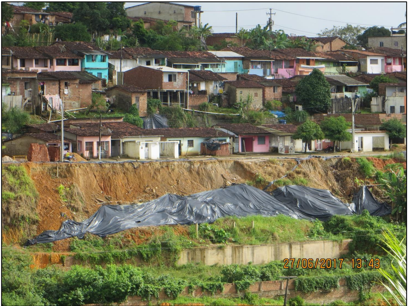
Foto 17: A rodovia PE-063, vista à distância, já com porções deslizadas e as cicatrizes dos deslizamentos visíveis no talude.
