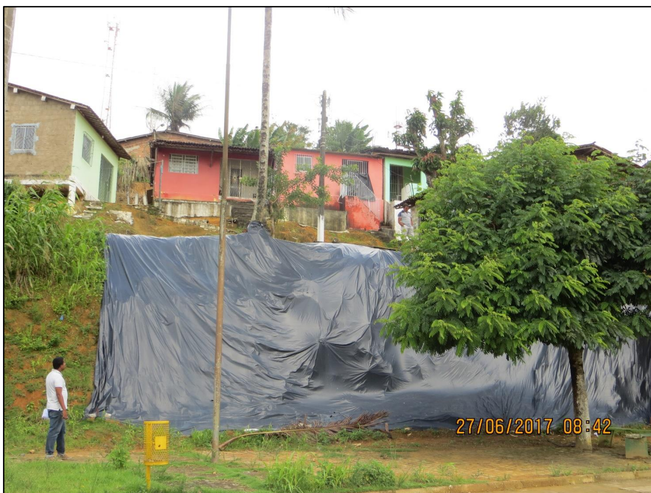
Foto 07: Lona plástica (proteção provisória) cobrindo encosta em risco de deslizamento.
