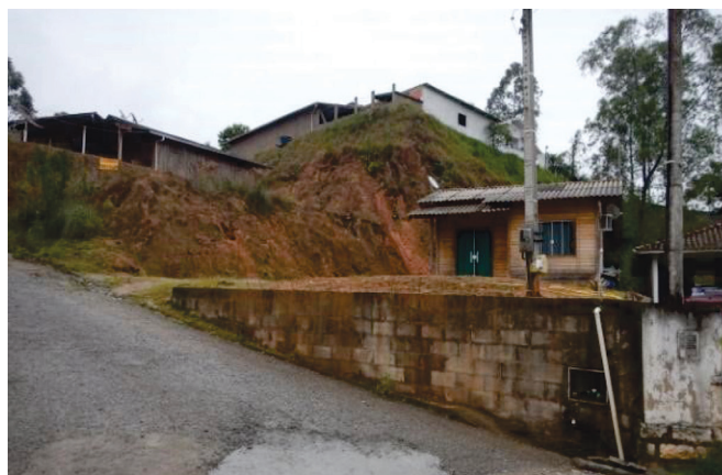
FIGURA 6 - Taludes de corte no bairro Caldas da Imperatriz. Fonte: arquivo do projeto.
