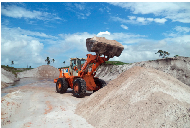
Figura 5.10 - Desmorte mecânico com utilização de pá carregadeira. Depósitos litorâneos – Marechal Deodoro/AL (Afloramento KC 020). Fonte: Klaryanna Cabral Alcantara, 2018.
