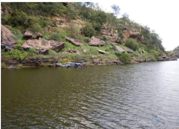
Figura 28 - Encosta movimentada com camadas descalçadas e blocos em balanço com sinais de evidentes de instabilidade.
