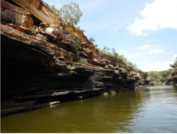
Figura 50 - Superfície denotativa de quedas de blocos posicionados na quebra de relevo da encosta com forte tendência a movimentação; presença de blocos em balanço e ação da vegetação aproveitando as fraturas para se instalarem.
