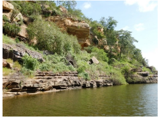
Figura 31 - Encosta íngreme, com camadas e blocos instáveis e rolados. Sinais de intemperismo e alteração do material rochoso e vegetação aproveitando as fraturas para sua instalação.
