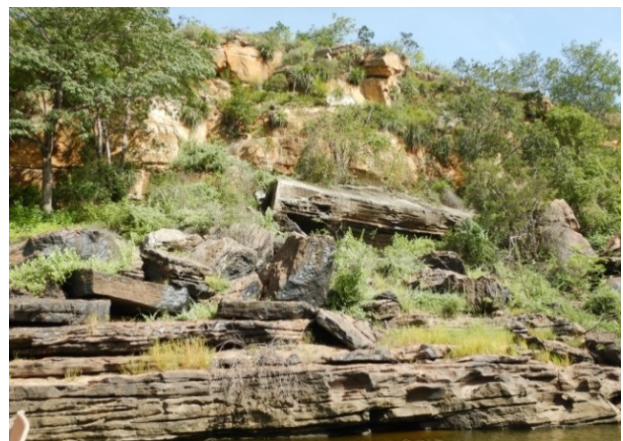
Figura 29 - Encosta movimentada com deslocamento e deslizamentos ao longo das descontinuidades intemperizadas pela ação da água que lubrifica e fragiliza este contato. Camadas mais espessas e intabilizadas no topo.
