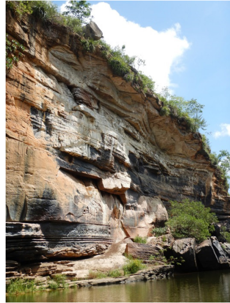
Figura 42 - Encosta com fortes sinais de movimentação de massa com blocos em balanço instáveis, descontinuidades alteradas e blocos instáveis no topo.
