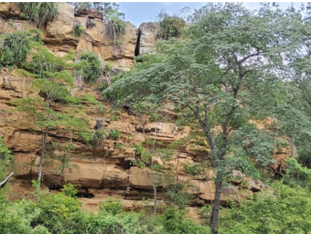
Figura 15 - Fraturas abertas e fechadas com individualização e instabilização de blocos.
