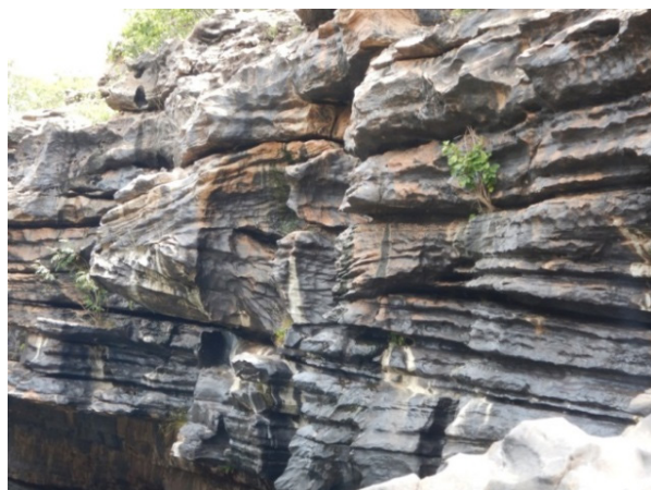
Figura 75 - Encosta fortemente tectonicizada e sob a ação erosiva da água com formação de ravinamentos, retirada de material entre camadas e cicatrizes de queda de bloco.
