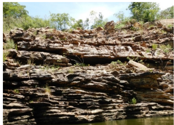
Figura 59 - Encosta com descontinuidade na forma de fraturas abertas e forte ação da água com retirada de finos e instabilizando os planos de estratificação da rocha. Presença de blocos em balanço.
