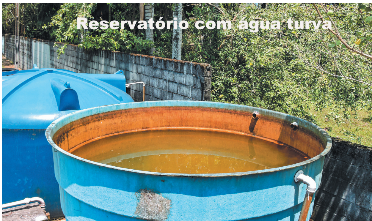
Figura 7.8. Reservatório com água turva bombeada diretamente do poço tubular.
