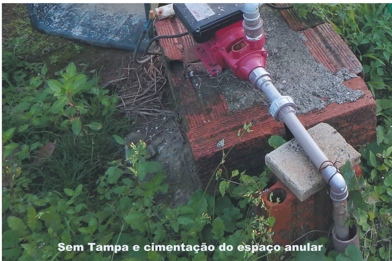
Figura 7.18. Poço de pequeno diâmetro sem tampa e desprovido de laje de proteção sanitária, exemplificando a situação bastante comum encontrada em Joinville.
