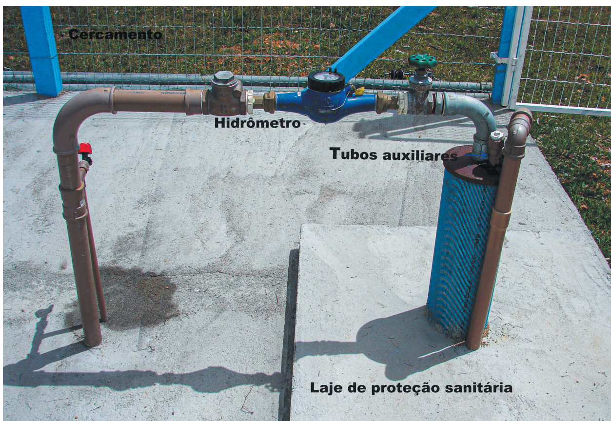
Figura 8.4. Exemplo de correta proteção sanitária de poço tubular, necessária para solicitação de outorga de captação de água subterrânea.
