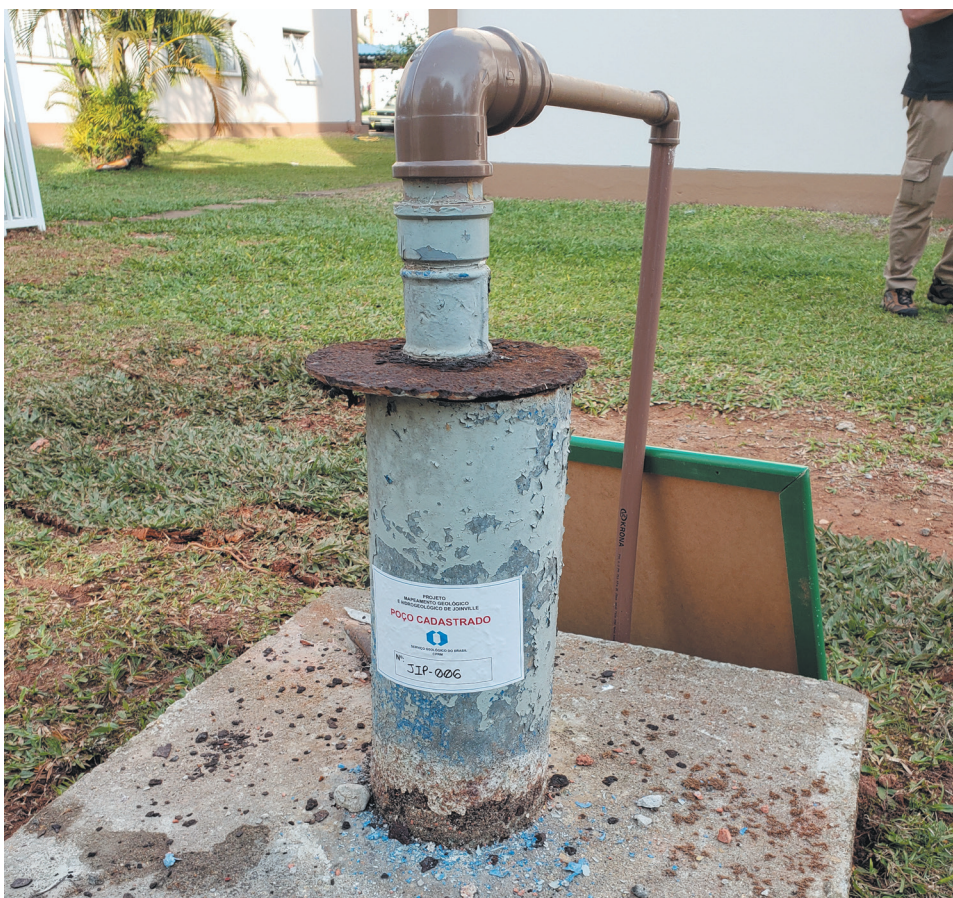
Figura 7.12. Início de corrosão na tampa do poço e na base do tubo de revestimento de aço galvanizado.
