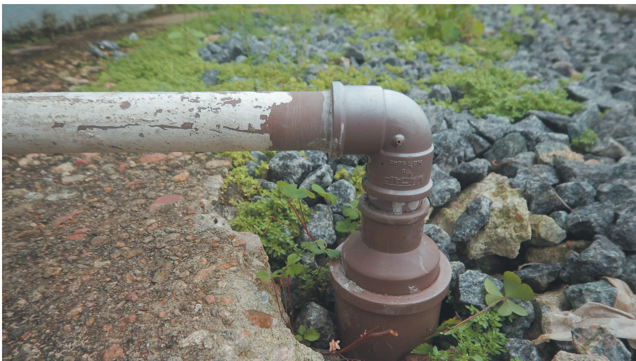
Figura 7.19. Poço de pequeno diâmetro residencial com tampa, porém sem laje de proteção sanitária.
