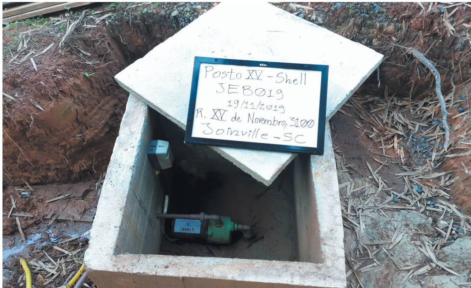
Figura 4.5. Poço de pequeno diâmetro com bomba centrífuga e com abrigo de proteção.
