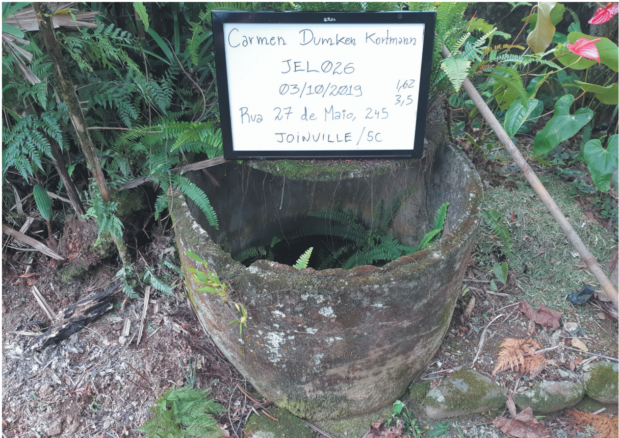
Figura 7.23. Poço escavado abandonado.
