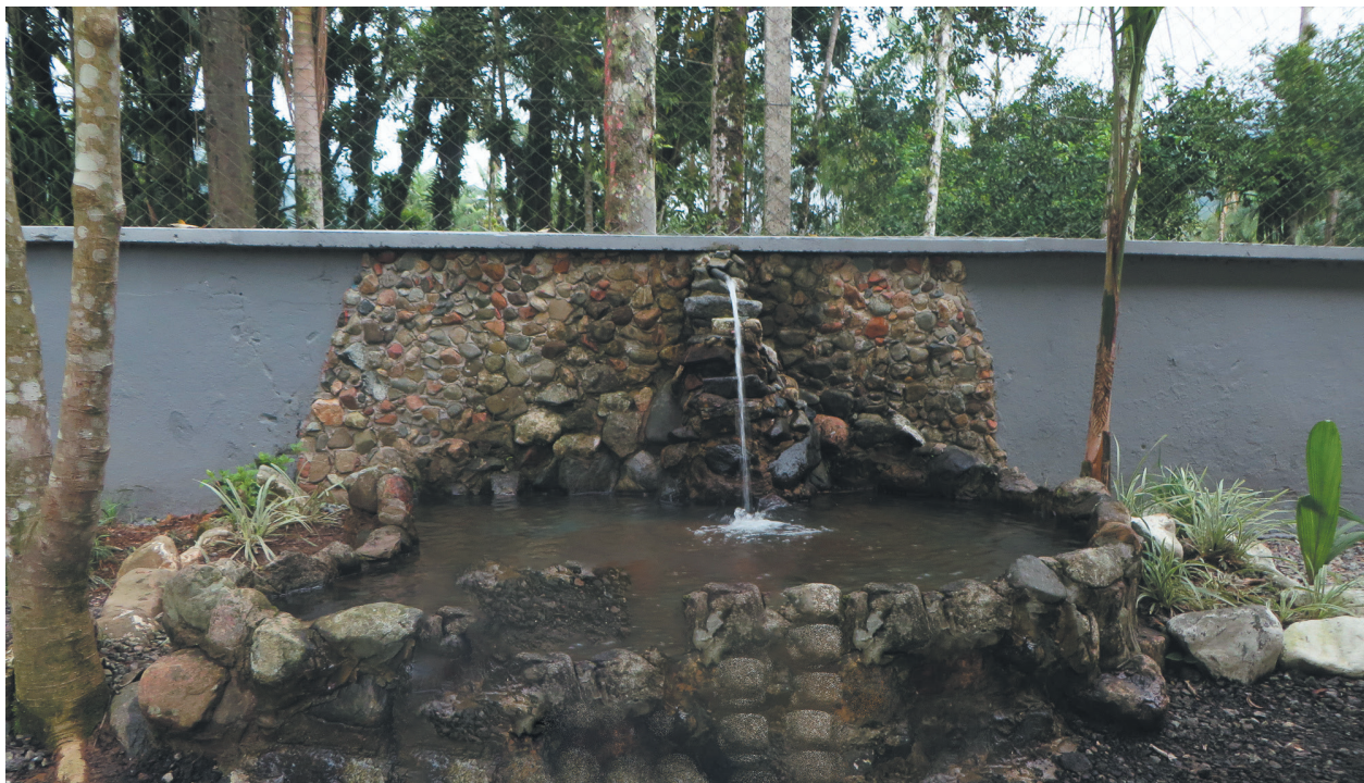
Figura 7.26. Exemplo de captação parcial de fonte natural, onde o restante da água segue seu curso natural.
