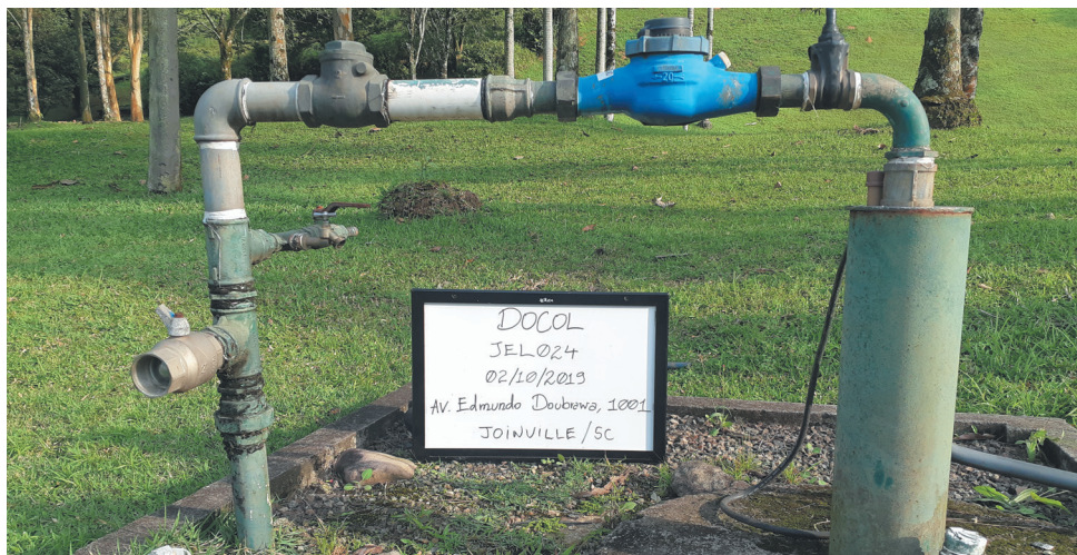
Figura 9 – Poço tubular profundo.
