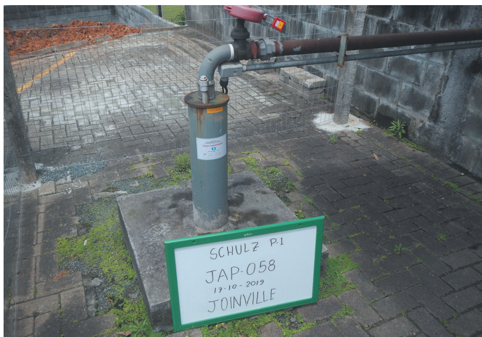
Figura 7.30. Exemplo de poço tubular que possui laje de proteção para a devida proteção sanitária.
