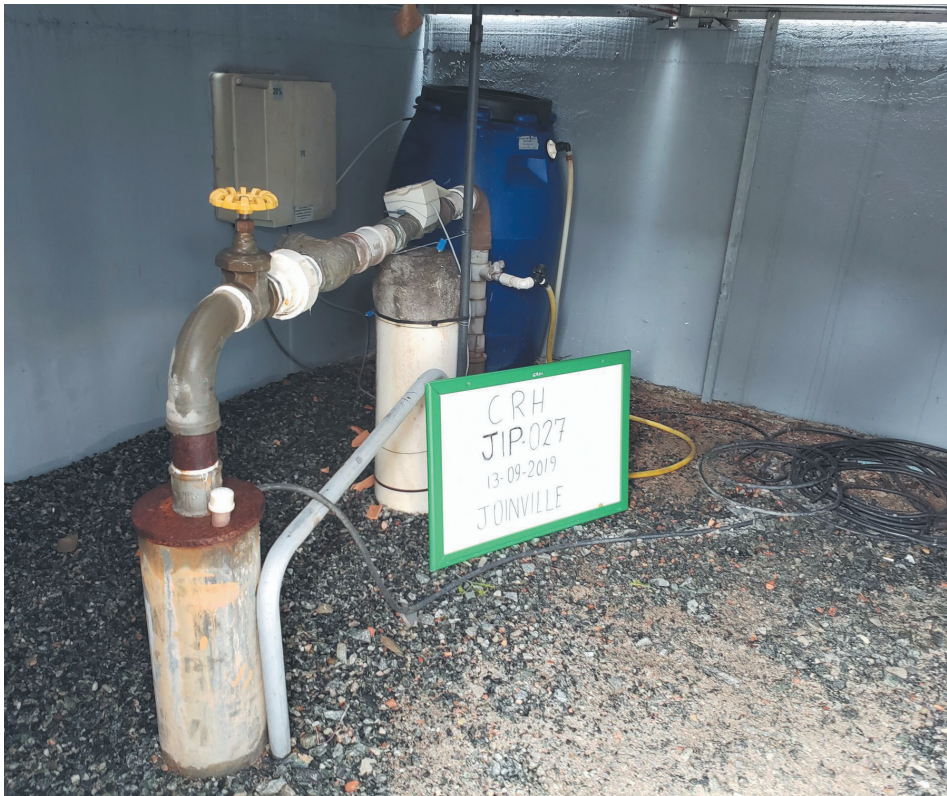
Figura 4.2. Exemplo de poço tubular. Local: Centro Empresarial CRH.
