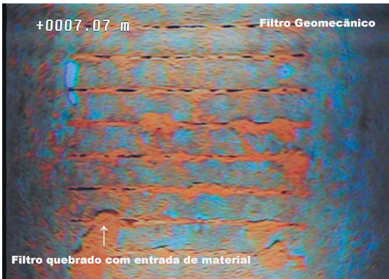
Figura 7.10. Imagem lateral da secção filtrante na profundidade de 7,07 metros, onde se observa a ranhura de filtro quebrada, permitindo a entrada de material da formação geológica para dentro do poço tubular.
