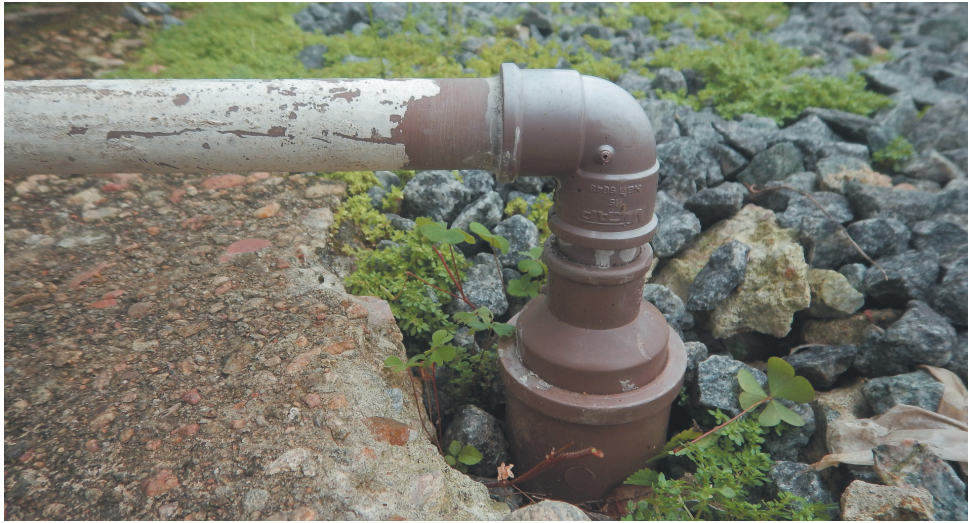
Figura 8 – Poço de pequeno diâmetro, revestido com tubo PVC de 50 mm.
