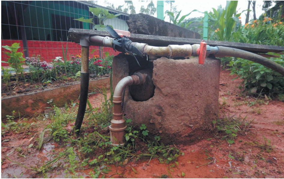
Figura 4.4. Exemplo de poço de pequeno diâmetro, também denominado poço ponteira. Em segundo plano dentro da manilha de concreto o conjunto de bombeamento.
