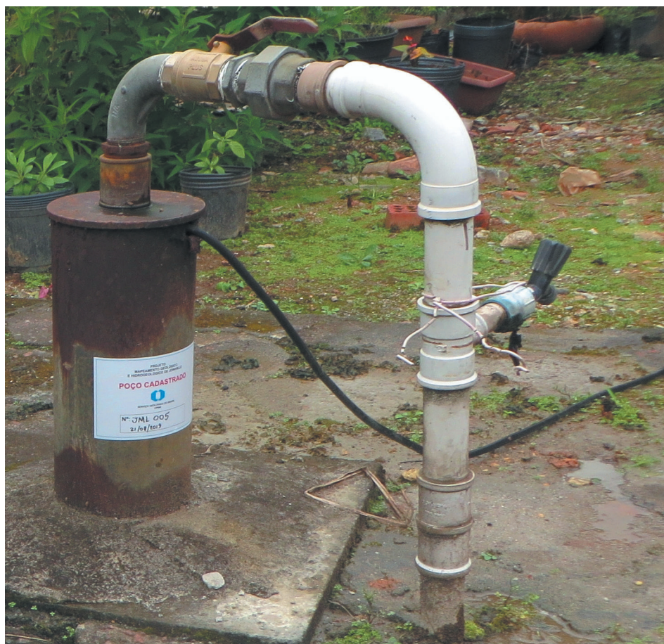
Figura 7.29. Situação mais comum encontrada no cadastramento de poços, onde não há hidrômetro, tubos auxiliares de medição de nível e cercado de proteção.
