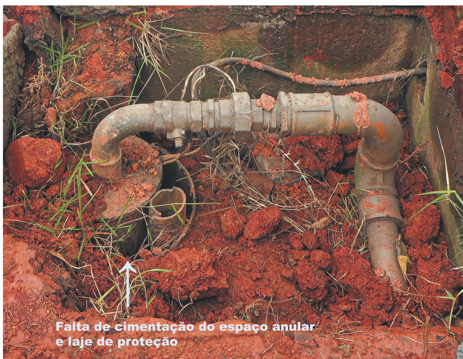
Figura 7.31. Exemplo de poço tubular sem a laje de proteção sanitária e em péssimas condições construtivas e de operação.
