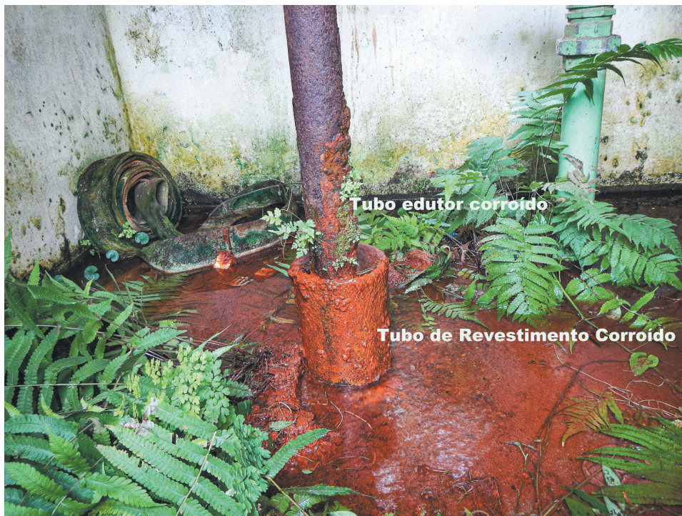
Figura 7.11. Tubo de revestimento e de educação corroídos no poço JAP-051 da antiga Cervejaria Antarctica.
