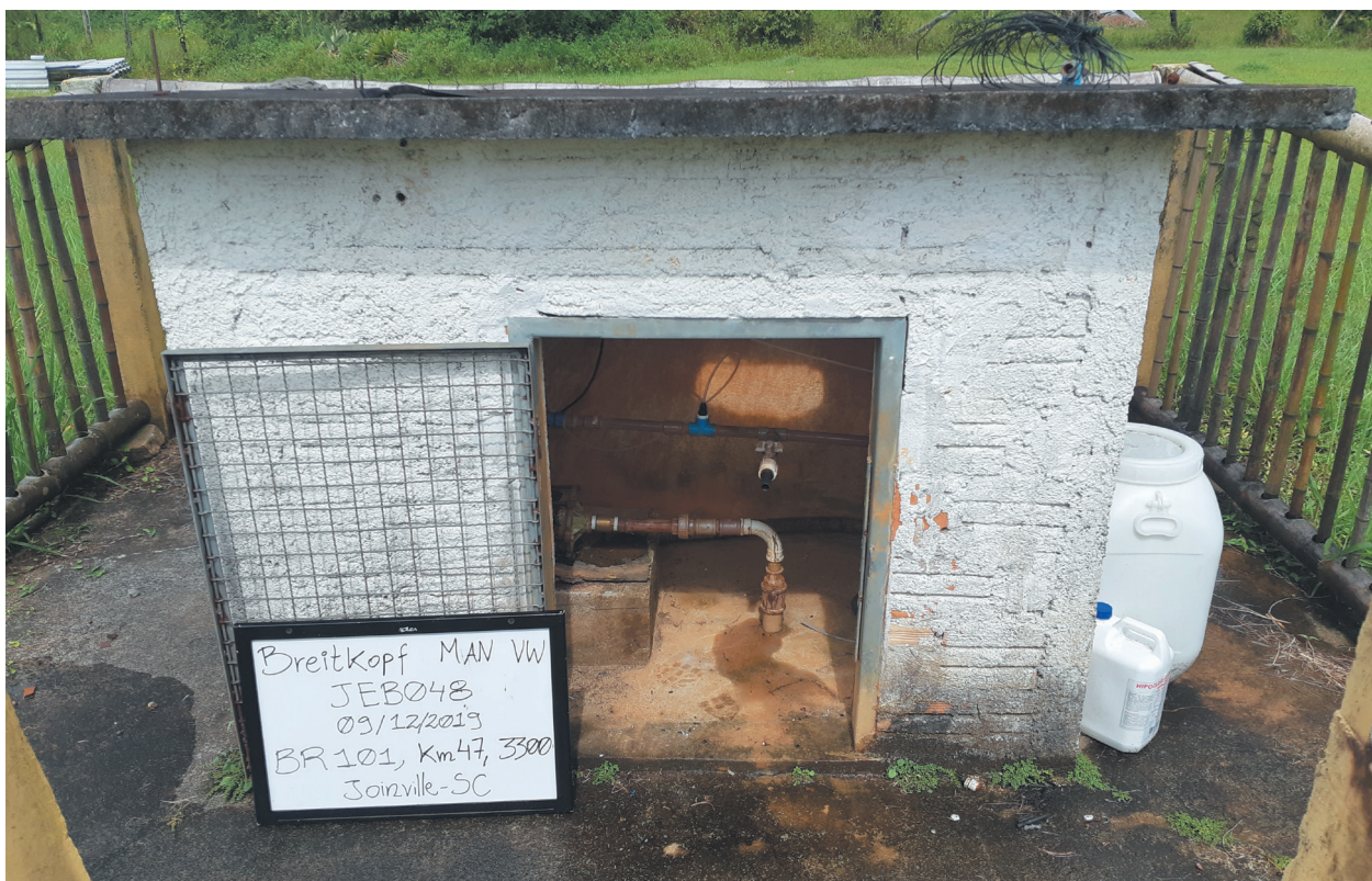
Figura 7.22. Poço de pequeno diâmetro com abrigo de proteção e cercado.
