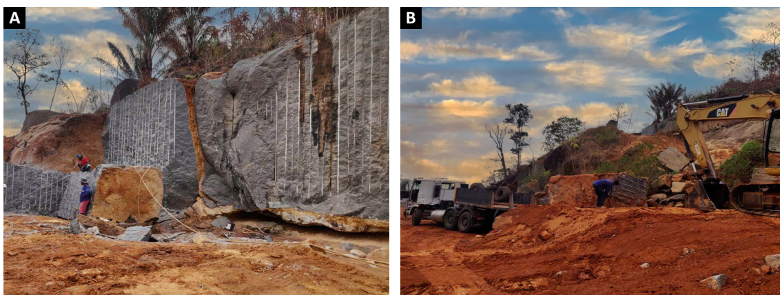
Figura 4.35 - Imagens da Pedreira do Roxinho, localizada no assentamento Lote Bom Jesus, em Roraima. (A) Frente de lavra em atividade; (B) Maquinário utilizado no carregamento dos blocos.
