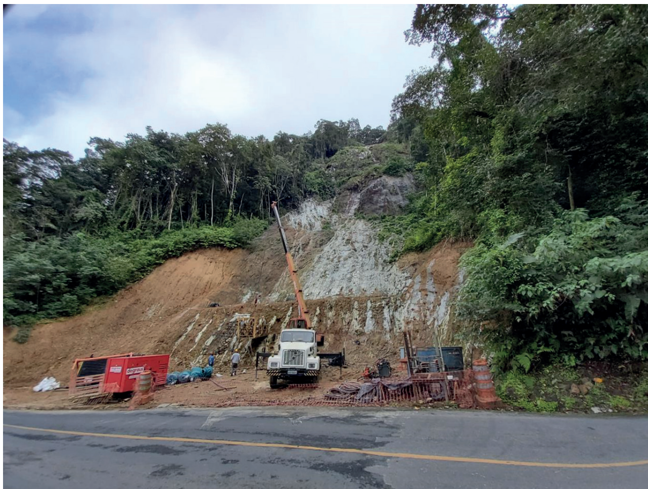
Figura 09 - Ponto 1: Cicatriz de deslizamento planar no vetor 4 na estrada de acesso à Praia do Guaraú, em fase de recuperação por obras de contenção.
