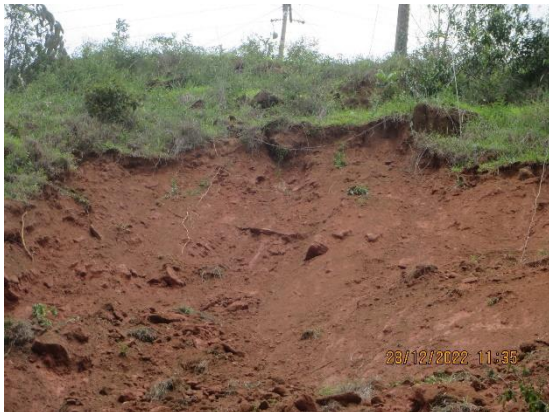
Figura 14. Aspecto do solo coluvionar observado na crista da ruptura principal. Notar a presença de blocos de rocha muito alterada na crista.
