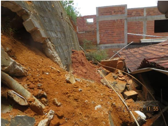
Figura 5. Colapso de muro e deslizamento ocorrido na Sede de Antônio Dias.
