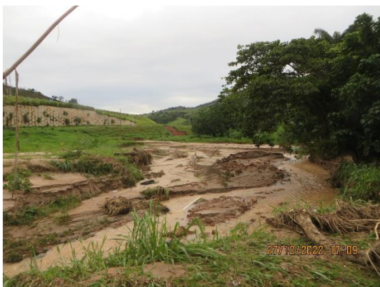
Figura 7. Córrego Severo mostrando marcas da enxurrada ocorrida no local.
