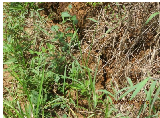
Figura 19. Outra trinca no solo observada acima de um dos deslizamentos.
