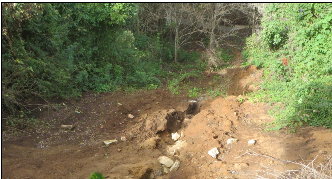
Figura 12 – Foto tomada a partir da crista do talude no início do deslizamento e onde se nota parte dos escombros da infraestrutura de alvenaria que protegia o sistema de filtragem da rede hidráulica, e que ruiu no deslizamento. Notar no alto, trecho do acesso que foi danificado pelo evento.
