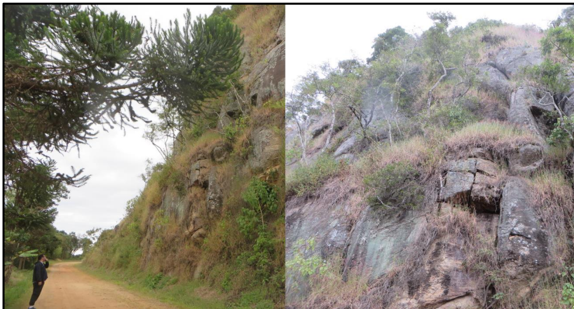
Figura 21 – Fotos a montante do acesso ao OPD mostrando maciço rochoso aflorante. Notar as várias famílias de fraturas que acabam individualizando blocos rochosos em posições instáveis no talude.
