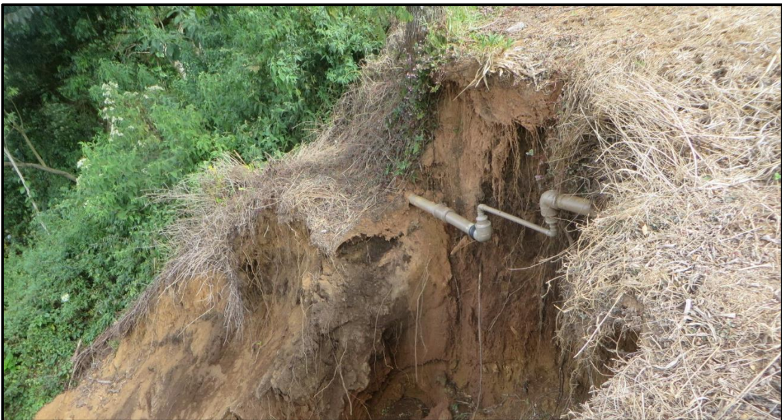
Figura 16 – Detalhe da posição e características da rede hidráulica na crista do talude. Notar que o deslizamento se inicia exatamente na posição da rede hidráulica. Notar escalonamento com degrau de abatimento que basculou parte da tubulação.
