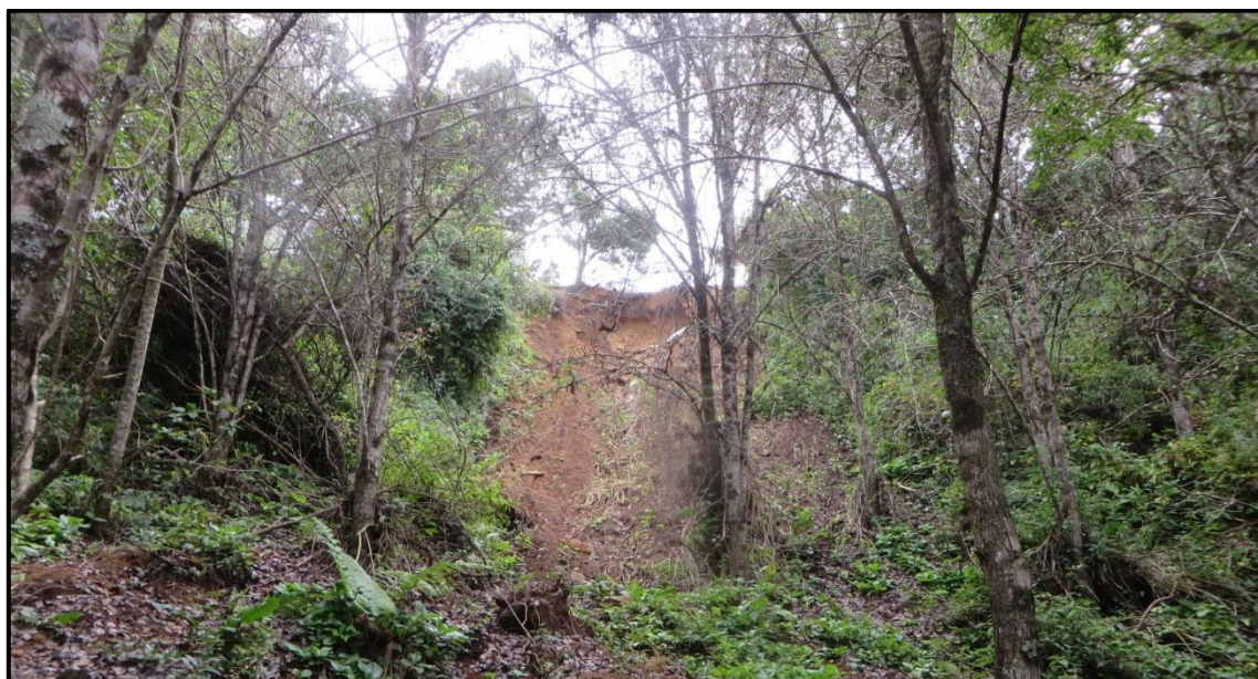
Figura 11 – Vista frontal da cicatriz do início do deslizamento planar ocorrido em 28 de dezembro de 2022, ruptura ocorrida na borda da área aterrada no entorno das instalações do OPD.
