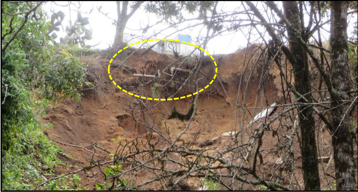
Figura 15 – Início da cicatriz de deslizamento mostrando a superfície de ruptura, a borda do talude constituída por aterramentos e a rede hidráulica na crista sob a marcação em tracejado amarelo.
