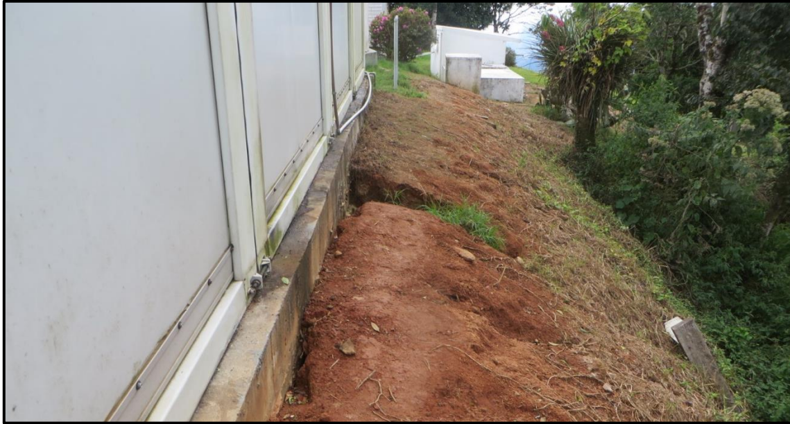
Figura 5 – Área aterrada a jusante das instalações do telescópio russo onde se observam sulcos erosivos e trecho do aterro reconstituído recentemente com solo avermelhado.
