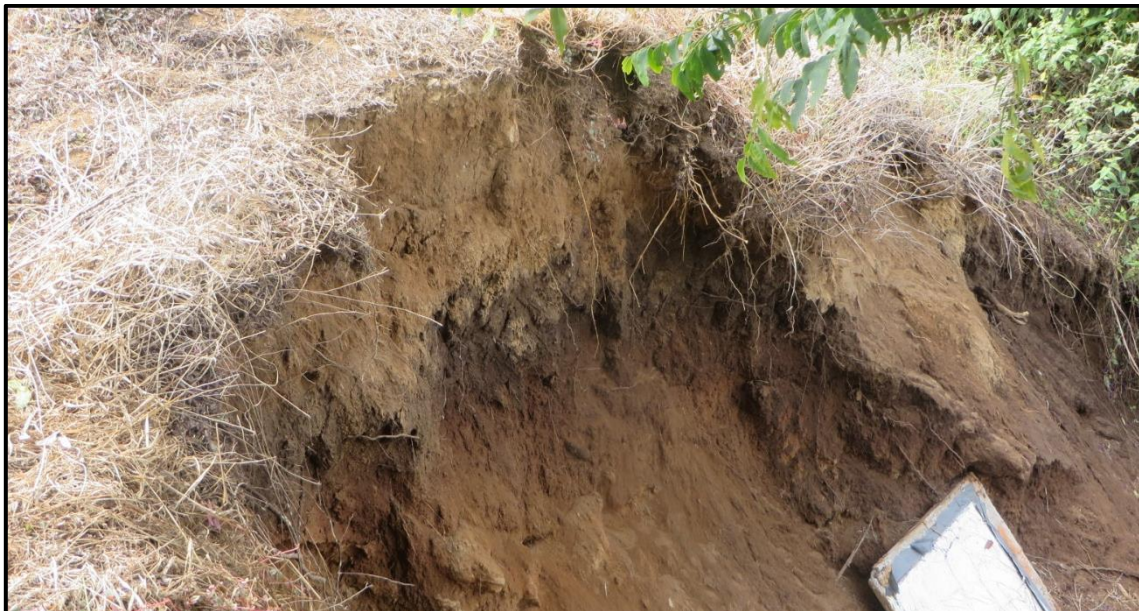
Figura 6 – Foto mostrando o início da cicatriz do deslizamento na borda do talude de aterro onde se observa camada escura, orgânica, possivelmente antiga serapilheira sepultada pelo aterramento. Notar parte da estrutura de alvenaria que ruiu com o deslizamento.
