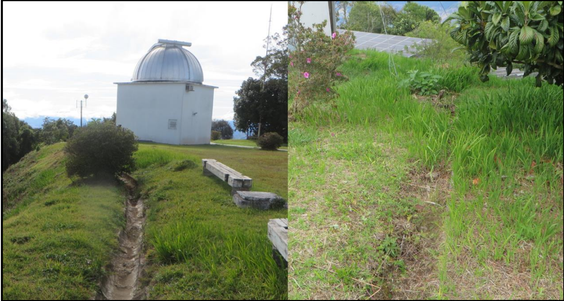
Figura 7 – Fotos mostrando as canaletas de concreto (meias-canas) do sistema de drenagem pluvial. Notar trecho obliterado na imagem da direita.
