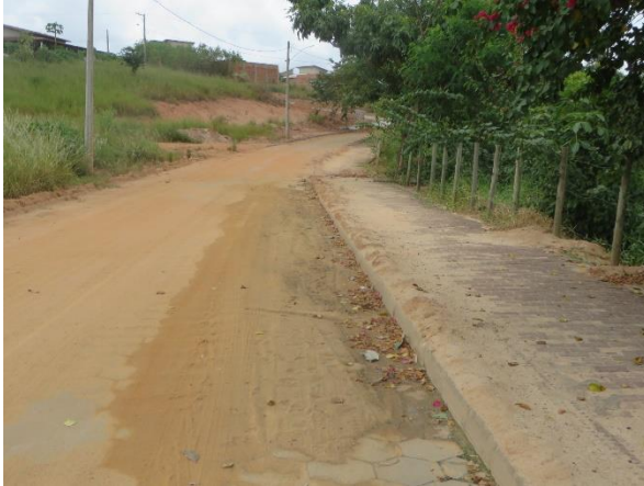
Figura 12: Aspecto da Av. Parque Itaúnas entre Rua das Laranjeiras e Zelita de Barros mostrando a grande quantidade de solo transportado por enxurradas.
