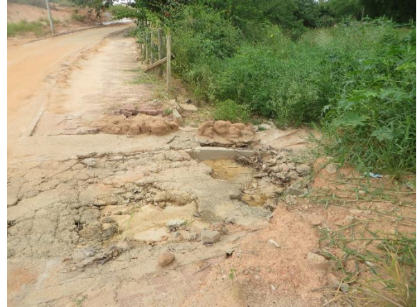
Figura 13: Trecho da Av. Parque Itaúnas onde as enxurradas adentram a área da APP e onde se observam danos no passeio produzidos por erosão.
