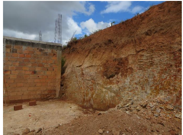
Figura 5: Foto do outro lado da edificação da imagem anterior, que mostra corte de cerca de 3,0 m em solo e saprólito de rocha granítica. Notar a proximidade da edificação e a inexistência de obra de contenção até este momento.
