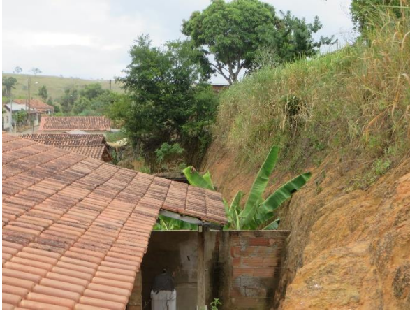
Figura 6: Casas edificadas sob cortes subverticais com cerca de 3,0 m de amplitude em solo e saprólito de rocha granítica. Notar que as casas estão bem afastadas da base dos cortes, exceto a primeira.
