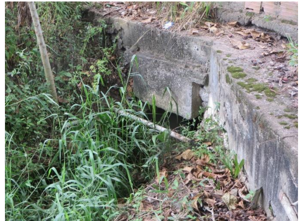
Figura 15: Trecho de galeria fluvial parcialmente entulhado por sedimentos e vegetação sob a Rua Paraíso, Distrito de Água Boa.
