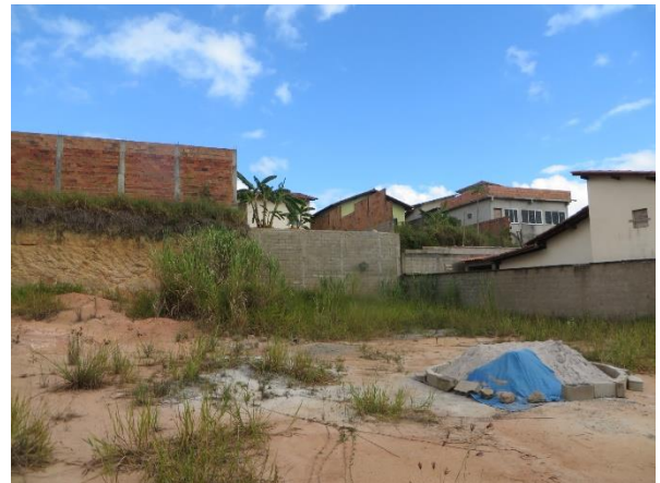
Figura 9: Continuação da figura 8, casa sob talude de corte de cerca de 3,0 m de amplitude contido por muro de arrimo. Av. Parque Itaúnas.
