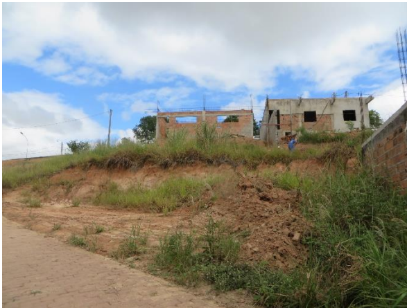
Figura 4: Desaterro e cortes de até 3,0 m de amplitude efetuados para ocupação à Rua Bem-Te-Vi, Bairro Planalto.
