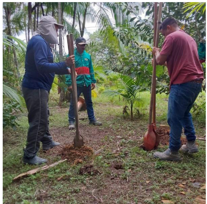
Foto: Início de abertura de furo de sondagem com utilização de cavadeira articulada (Município de Barcarena – PA, 2023).
