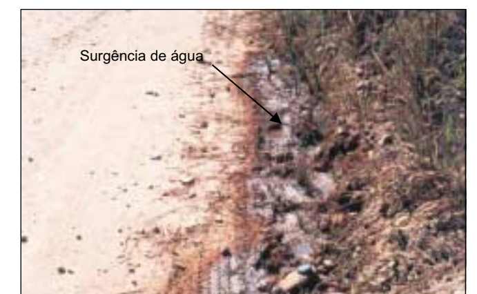
Foto 86 - Lençol freático minando no leito da estrada que expõe o contato entre solos arenosos permeáveis e os sedimentos argilosos impermeáveis.
