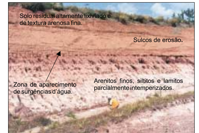
Foto 93 - Detalhe da foto anterior, mostrando sulcos de erosão formados a partir do contato entre os solos superficiais arenosos com os sedimentos areno-siltico-argilosos.
