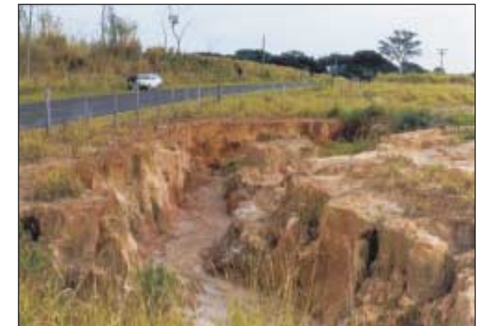
Fotos 64 - Voçorocamento induzido pela falta de disciplinamento e pela concentração de águas pluviais nas margens das estradas é bastante comum ao longo de toda a área de definição dos domínios 5 e 6.
