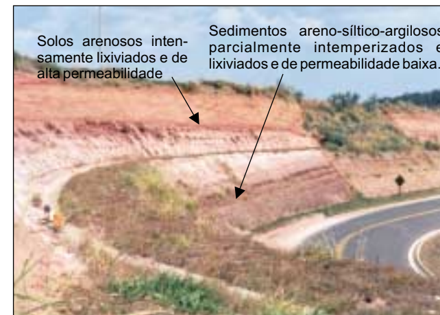
Foto 92 - Talude de corte de estrada, sem obras de revestimento.
